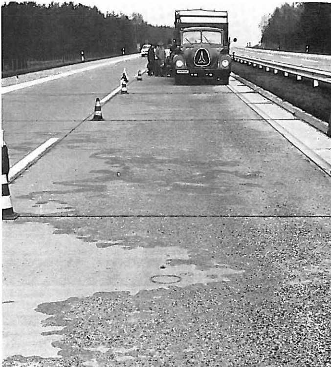
Bild 1 Beispiel einer Betonfahr- bahn mit „starker“ Abwit- terung durch Tausalze
