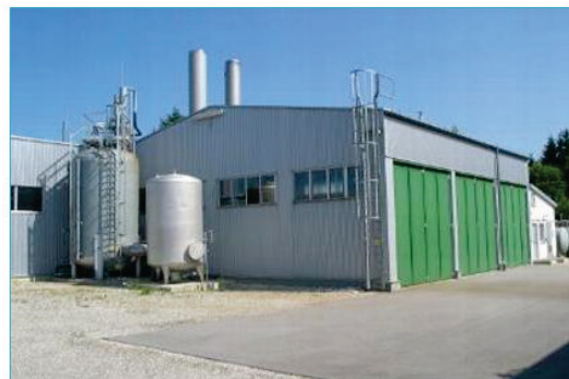
Abbildung 30: Heizwerk in Braunau/Simbach. (Quelle: Energie AG OÖ Wärme GmbH)
