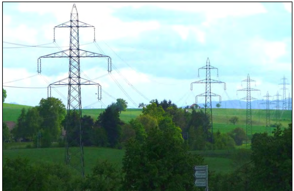
Abbildungen 81 + 82 Die steigende Anzahl dezentral Strom produzierender Anlagen (im oberen Bild die Photovoltaikanlage in Ziegelhus, Gemeinde Alterswill, mit rund 60 kW Leistung) und Energieversorgungssicherheit stellen hohe Ansprüche ans Elektrizitätsnetz (im unteren Bild die Hochspannungsleitung beim Steinler (Düdingen)). Photos: M. Gutschner
