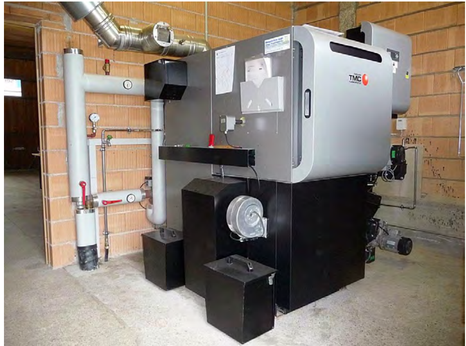
Abbildung 74: Nebst den grösseren Holzwärmeverbänden bestehen im Sensebezirk eine Reihe weiterer kleinerer Anlagen wie dieser Heizkessel mit einer Leistung von 100 kW (Baujahr 2009) im Weiler Litzistorf (Bösingen). Photo: M. Gutschner
