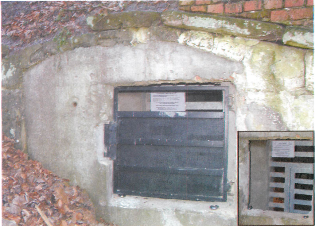
Abb. 10. Doppelte Sicherung des mehrfach aufgebrochenen Brauereikellers Cortendorf im FFH-Gebiet "Veste Coburg, Bausenberger und Callenberger Forst" (kleines Bild mit geöffneter erster Tür). Aufn.: G. HÜBNER
