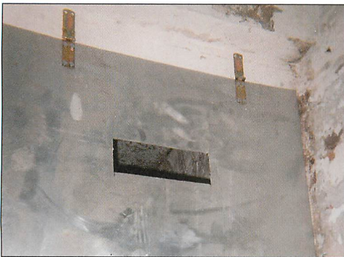
Abb. 48. Bunker „Sella Nord“/Königsbrücker Heide: Frostschutz durch innerhalb des Bunkers angebrachte Klapptür mit Durchflug.
