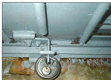
Abb. 19. Bunker Lossow: Schloss unter der Stahlplatte.
