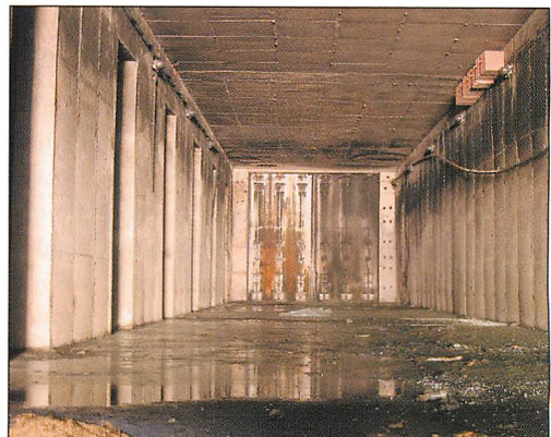
Abb. 35. Bunker im ersten Winter nach der Optimierung (nass!).
