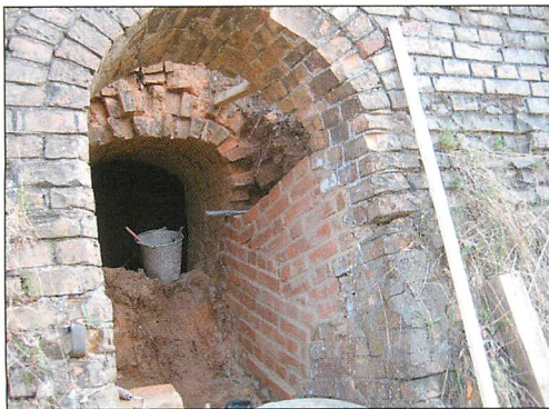
Abb. 38. Ringofen Schiffmühle: Eingestürzte Gewölbeteile und Öffnungen – Durchfrieren des Quartiers und Gefahr für die Quartierbetreuer.
