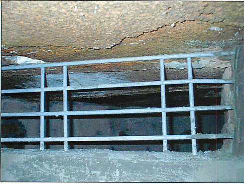
Abb. 40. Bunker Lossow: Sicherungsgitter gegen Eindringlinge, das zugleich als Belüftungsöffnung und Einflug für Fledermäuse dient.
