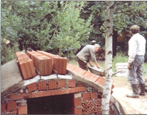
Abb. 27. Quartier Nr. 15. Porotonblöcke, die die Hangnischen für die Fledermäuse enthalten, wurden aufgelegt.
