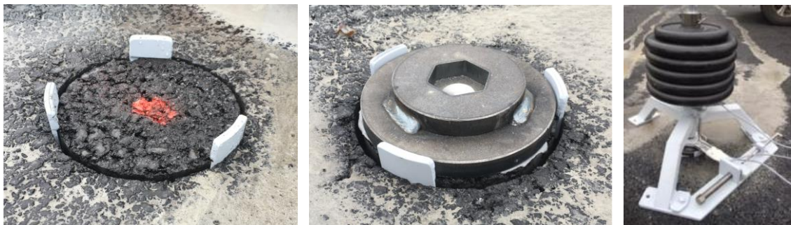
Abbildung 43: In-situ Prüfvorrichtung zur Bestimmung des vorhandenen Schichtverbunds zwischen Asphalt- und zementstabilisierter Tragschicht: (links) gestoppte Kernbohrung und stabilisierter Kern, (Mitte) Ankleben der Lasteinleitung und (rechts) Aufsetzen des Prüfgeräts
