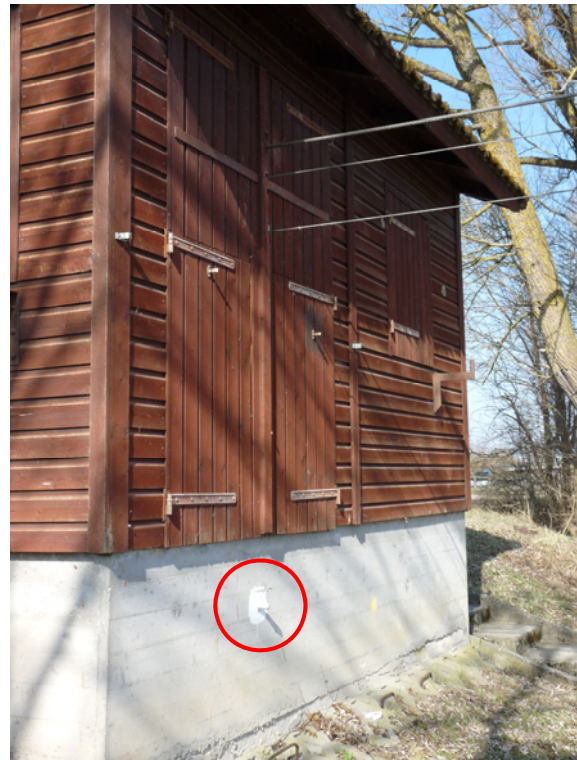
Bild 6: Negativbeispiel: Pegelfestpunkt unterhalb der Verschalung und der Stahlseile der SKA
