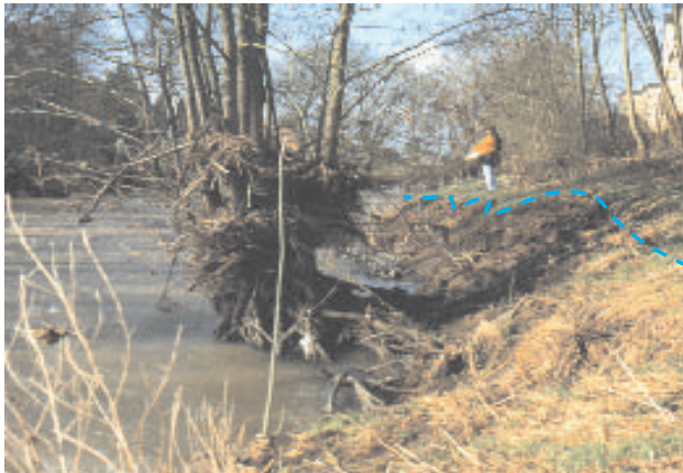
Abb. 30: Abtrag von Boden durch einen Uferbruch während eines Hochwasserereignisses. Infolge des Baumes kam es zu einer lokalen Verengung des Abflussquerschnittes. Es fand eine Umströmung des Hindernisses statt, die aufgrund hoher Fließgeschwindigkeiten Erosion entlang der Uferböschung bewirkte. In den Ästen des Baumes hat sich Geschwemmsel abgelagert.
