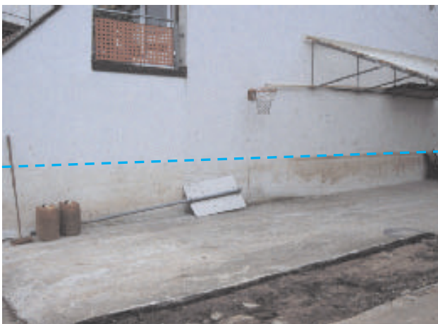
Abb. 31: Anhand der Verschmutzung des Gebäudes kann man den maximalen Wasserstand eines Hochwassers ableiten.
