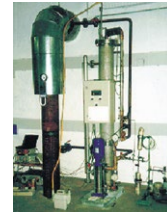
Servitec Versuchsanlage in einer Wärmeübergabestation der Energieversorgung Halle
