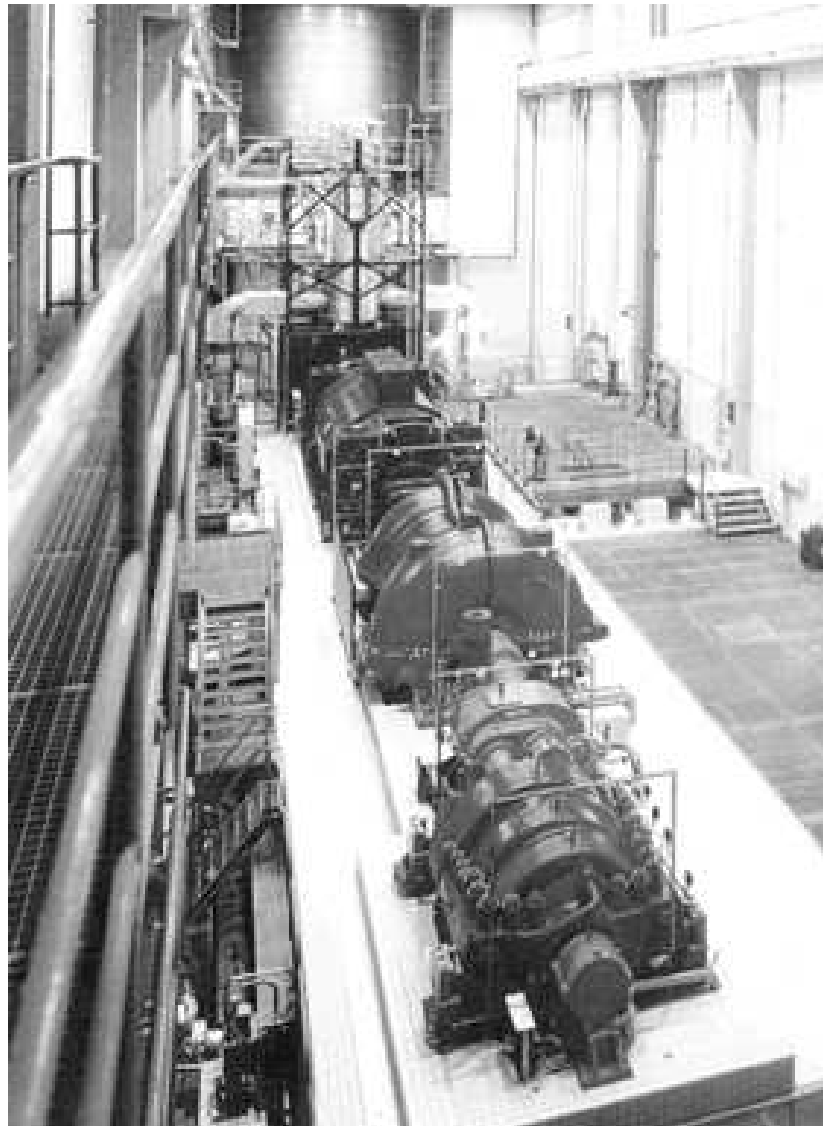
Abbildung 5.4: Antriebsstrang Kraftwerk Huntorf [15]
