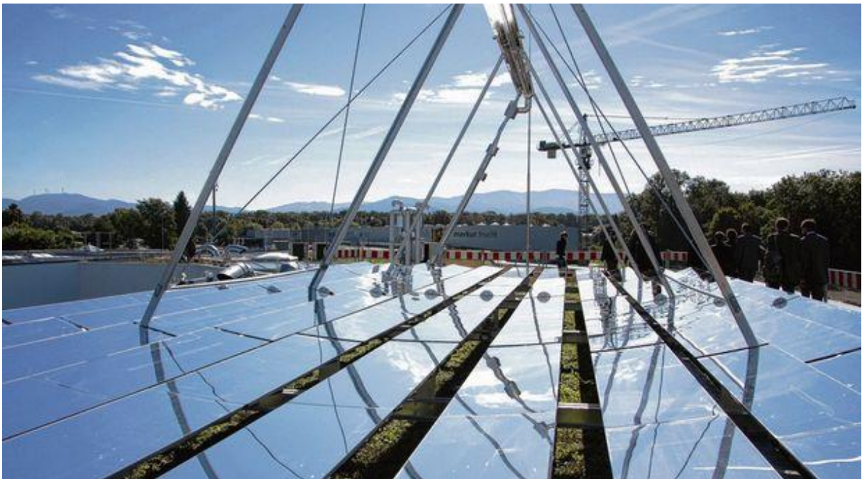
Abbildung 2-11 Versuchsanlage der Kramer GmbH in Umkirch zur solaren Kälteerzeugung
