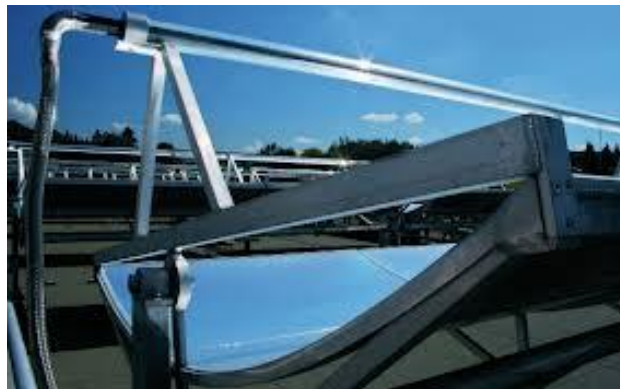
Abbildung 2-8 Blick auf den Receiver und die Verrohrung des Parabolrinnenkollektorfeldes der Alanod Aluminium-Veredelung GmbH & Co. KG
