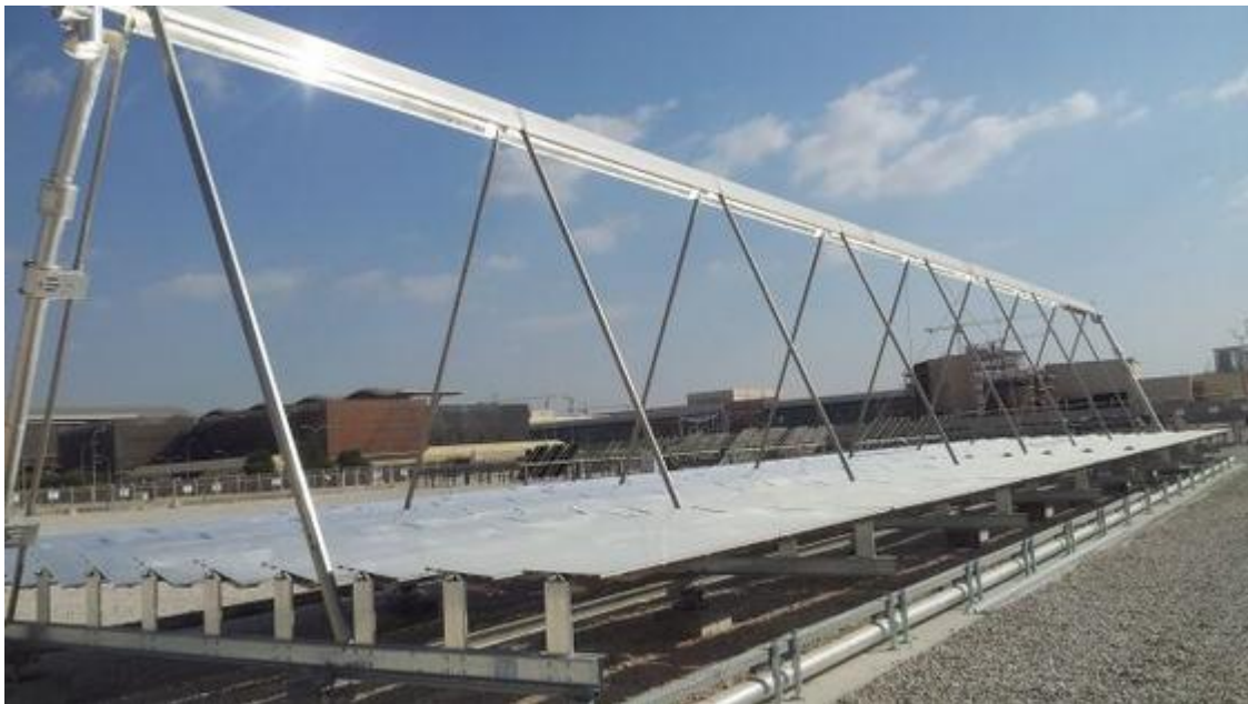
Abbildung 2-10 Fresnel-Kollektor der Firma Industrial Solar aus Freiburg
