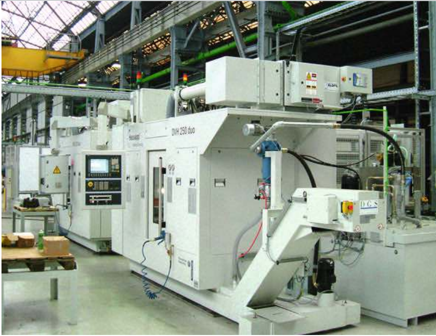
2 Nach und nach hat Tyrolit inzwischen alle Zentrifugen durch die elektrostatischen Abscheider Elofil von ILT ersetzt. Hier im Bild eine vergleichbare Anlage eines ILT-Kunden
