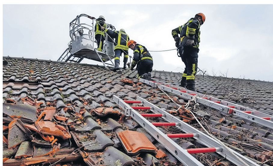
Feuerwehrlente sichern das Dach des Tutzinger Kinohauses, auf das durch den Sturm eine Baumkrone gefallen ist. FOTO: FEUERWEHR TUTZING
