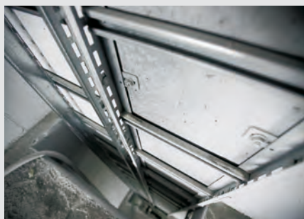
Befestigung von Kabelleitern
