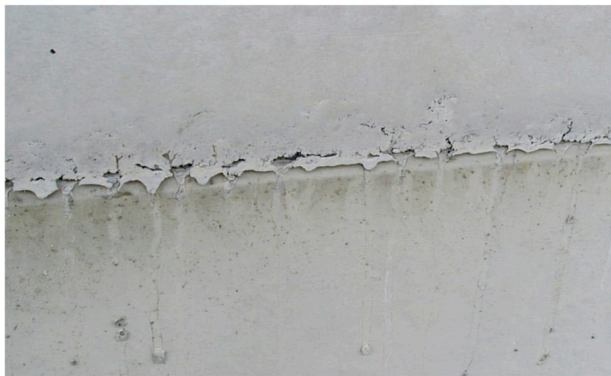
Zementleim und Feinstmörtelverlust durch undichte Betonierfuge.
