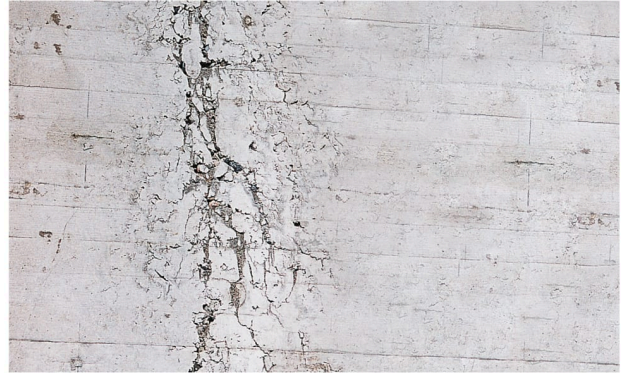
Schleppwasserkanäle durch Aufsteigen von überschüssigem Zugabewasser an senkrechter, geschalter Betonoberfläche.
