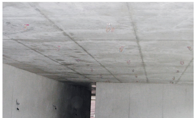
Abzeichnen der undichten Schalungsfugen durch Verlust des Zementleimes, auf den Feldmitten helle Ausblühungen.
