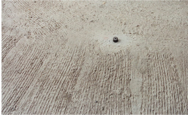
Abmehlungen und Absandungen auf einer Bodenplatte als Folge des starken Bluten von Beton.
