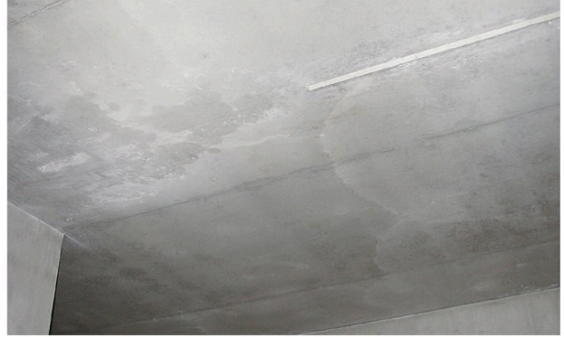
Grossflächige Wolkenbildung durch ungenügender Durchmischung und Wasserabsondern des Frischbetons.
