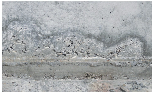
Kiesnest im Wand-Bodenanschlussbereich infolge ungenügender Verdichtung und Austreten von Feinstmörtel bei undichten Schalungstößen.
