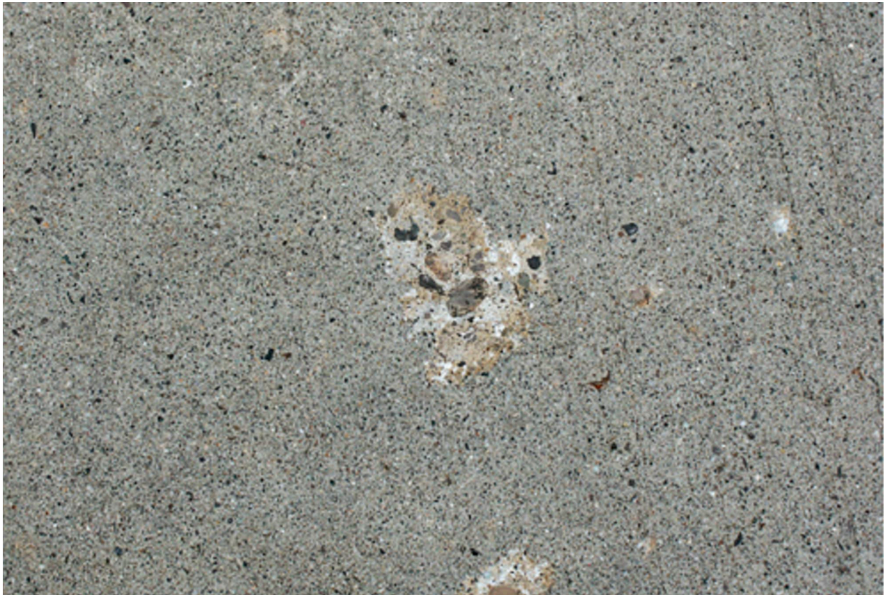
Abb. 8.5.1: Schäden infolge Abplatzungen über nicht frostbeständigen Gesteinskörnern.
