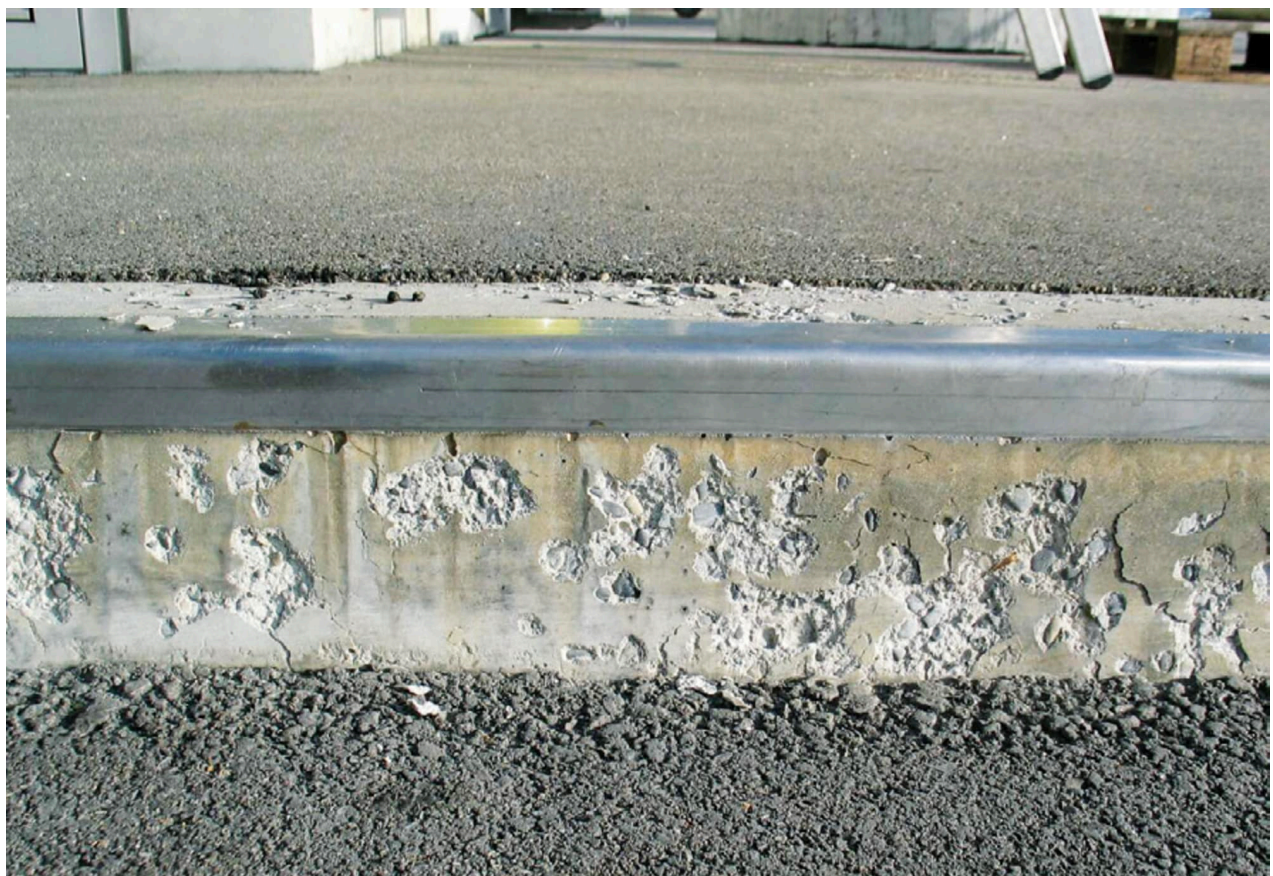
Abb. 8.5.2: Flächige Abplatzungen an einem Betonrandstein.
