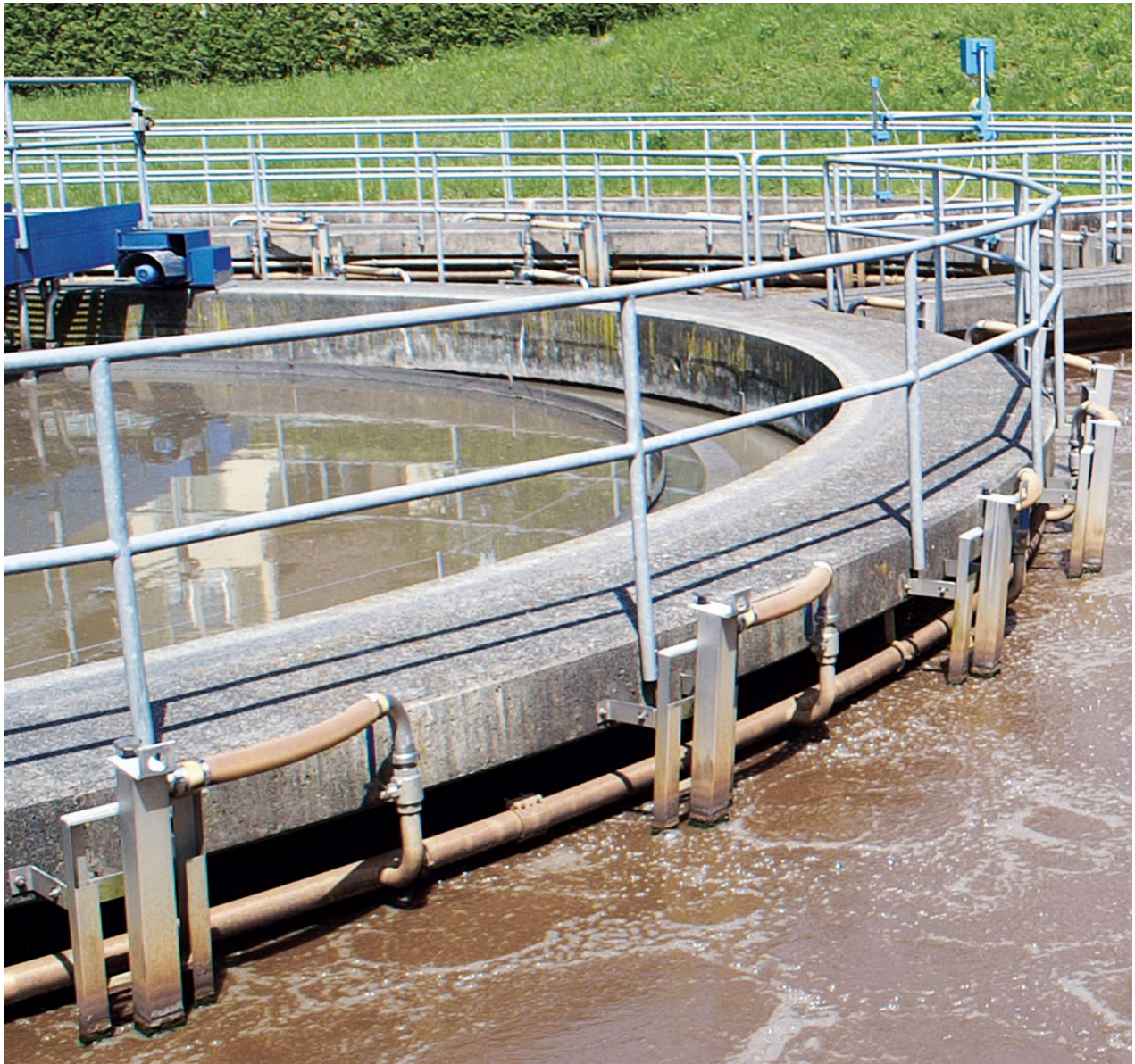
Abb. 8.5.6: Räumerbahn einer Kläranlage mit hoher Frost-Tausalzbelastung.
