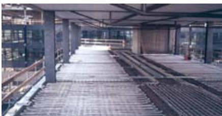
In die Decke integriertes Heizungs- und Kühlsystem
