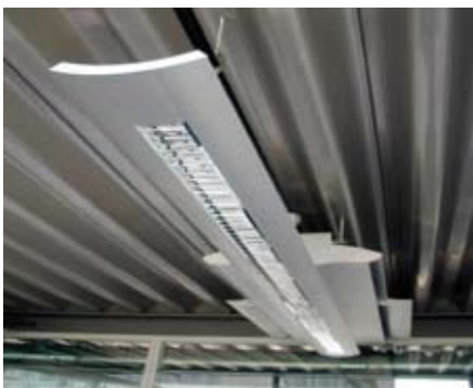
Edelstahldecken mit Beleuchtung und Lüftungsgeräten
