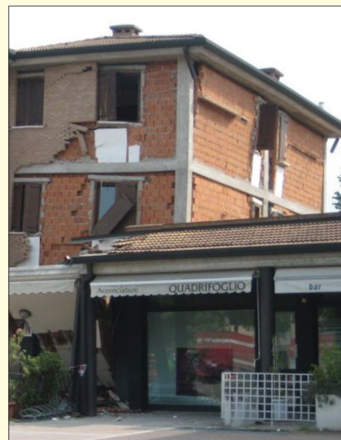
Schädigung von Ausfachungswänden in und senkrecht zur Ebene
