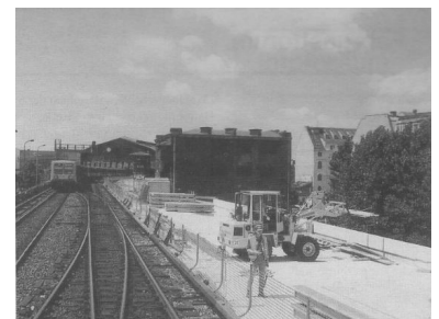
Bf Friedrichstraße. Hier wurde erst im August mit dem Abriß des S-Bahnsteiges. Der Bahnhof soll für ca. 113 Mio DM völlig umgestaltet werden. (Foto: Marc Heller)
