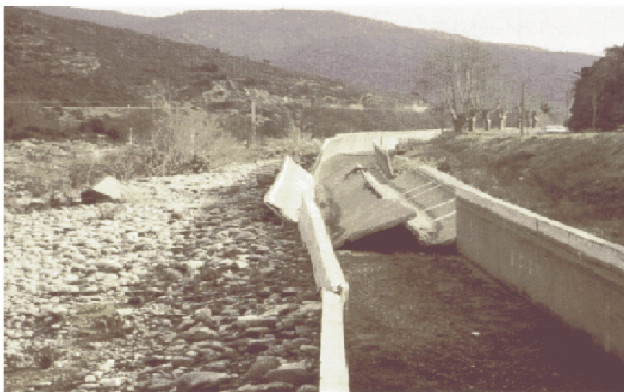
Bild 4.12: durch Auftrieb zerstörter Kanal
