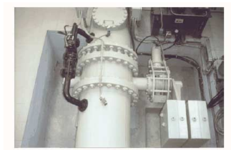
Bild 5.14: Hydraulisch bedienbare Drosselklappe
