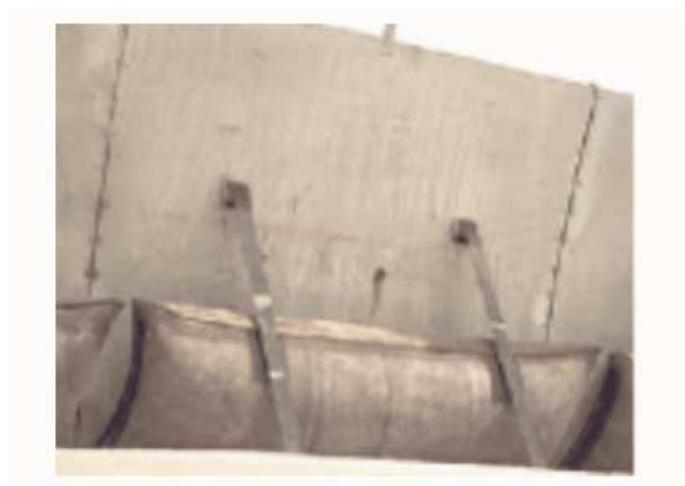
Bild 5.6: Schlauchwehr mit Stahlplatte
