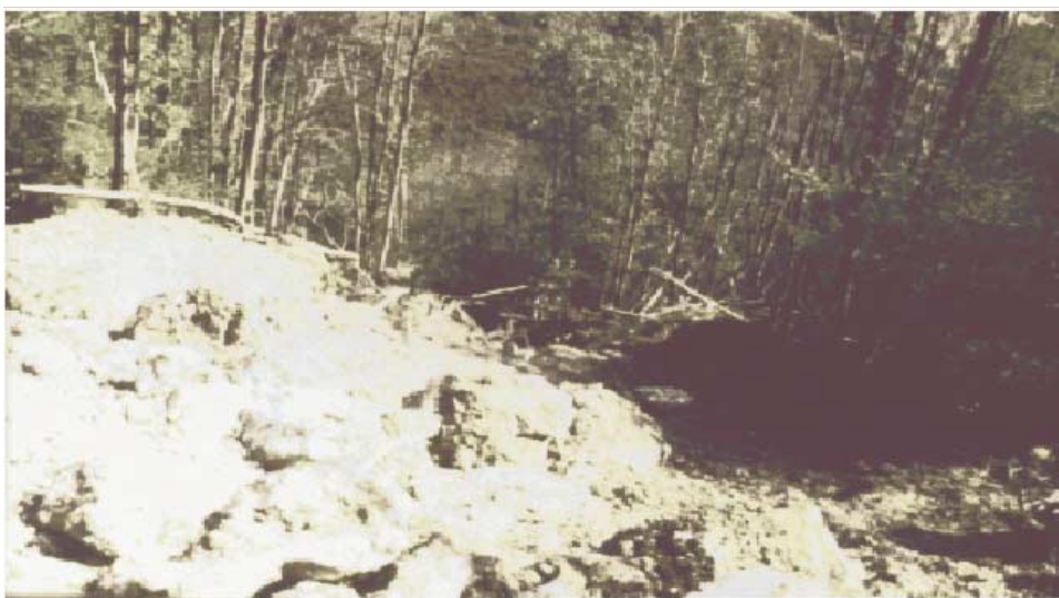
Bild 4.10: Undichtheiten und Auswaschung unter der Wehranlage
