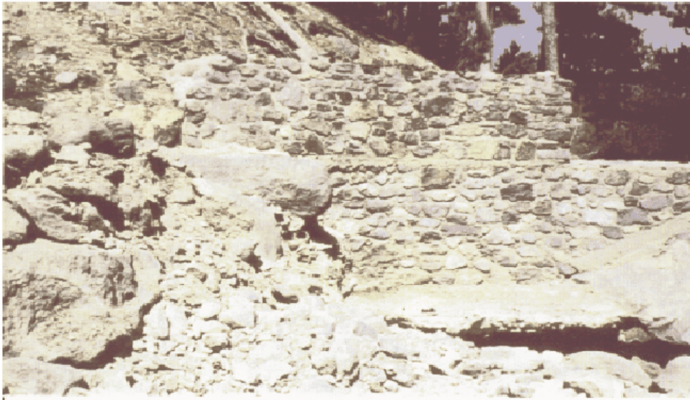
Bild 4.11: Undichtigkeiten und Auswaschung unter der Wehranlage
