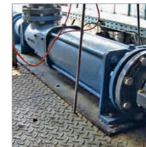
Substratförderung zwischen Fermentern
