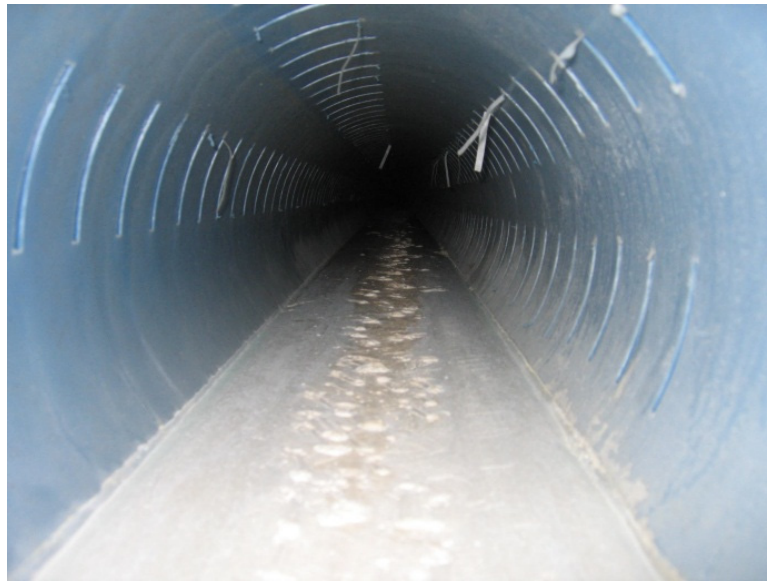
Bild 1: Versinterungen in Drainageleitungen [Bild: Testor, BEG]
