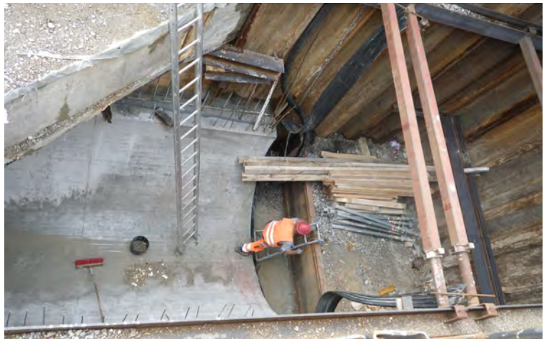
Baumaßnahme Laimer Kreisel: die Baustelle der Münchner Stadtentwässerung wurde in offener Bauweise hergestellt.
