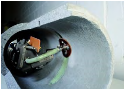
Verspachteln von Rissen und sonstigen Fehlstellen in einem nicht begehbaren Kanal mittels Robotertechnik
