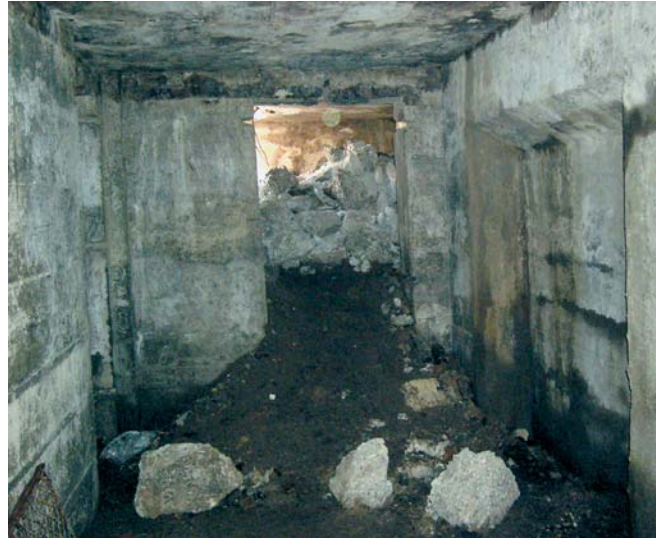
Abb. 2: Verschütteter Stiegenabgang zum ersten Tiefgeschoß und Abgang zum zweiten Tiefgeschoß (links). (Foto: M. La Speranza)
