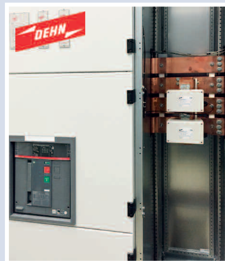
VAMOCON-Anlage mit System DEHNshort
