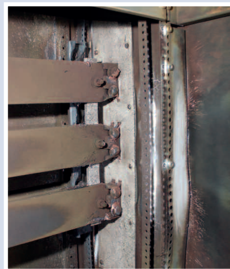
Nach erfolgreichem Test: Störlichtbogen wurde im Feld gehalten
