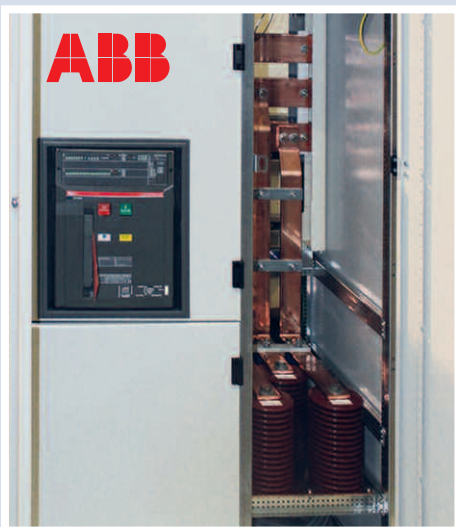
VAMOCON-Anlage mit System ABB UFES
