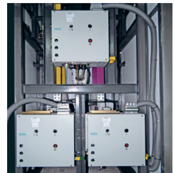
Beispiel Retrofit-Installation eines 3AH37 Generatorschalters
