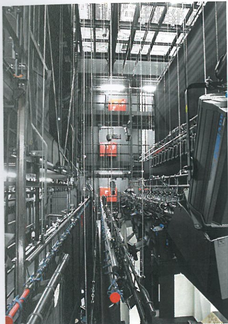
BLICK QUER IN DEN BÜHNENTURM MIT DEN LASTSTANGEN DER E-ZÜGE ALS RUNDROHRLITERN
