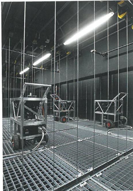
DIE 6 PUNKTZÜGE SIND ALS STAHLBANDZÜGE DER FA. ASM MIT NL 250 KG AUF DEM SCHNÜRBODEN FREI VERSETZBAR.
