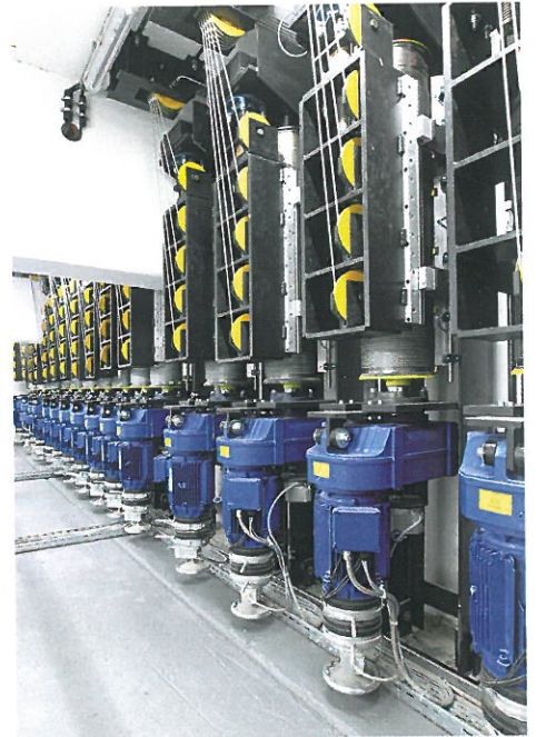
DIE WINDEN DER OM SIND IN SEPARIERTEN WINDENRÄUMEN ANGEORDNET, WELCHE ZUR HAUPTBÜHNE HIN LEDIGLICH DIE ÖFFNUNGEN FÜR DIE SEILVERZÜGE...
