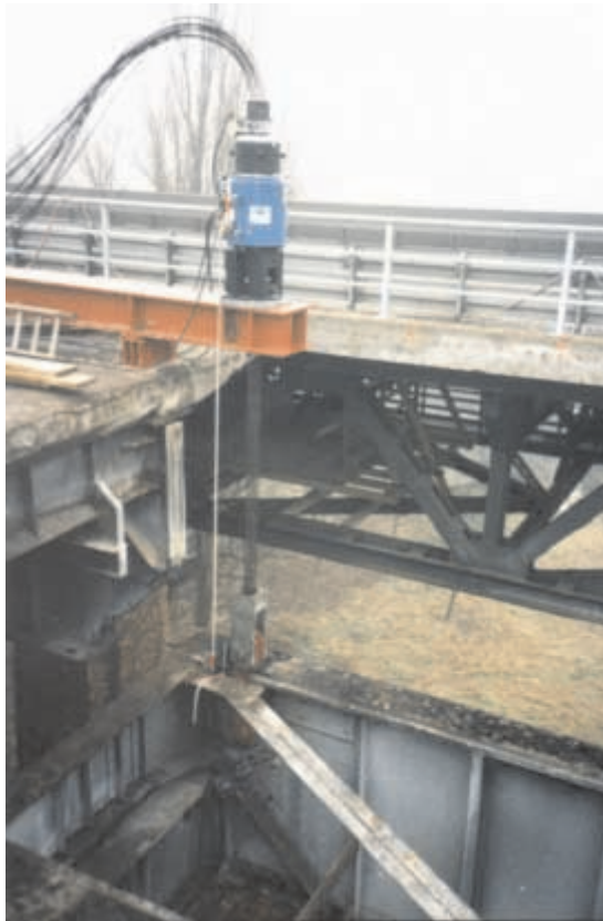
Bild 10.4: Litzenhebereinsatz zum Ablassen Einhänger, Kalkgrabenbrücke, BAB A 10
