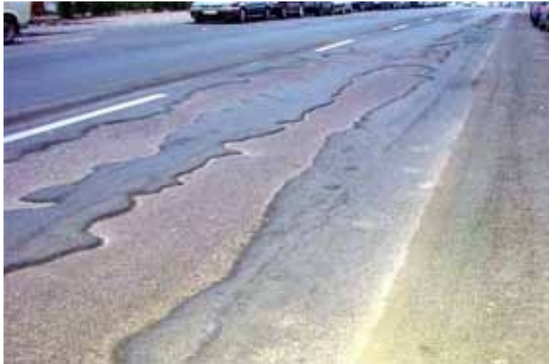
Ablösung der Deckschicht einer flexiblen Straßenbefestigung
