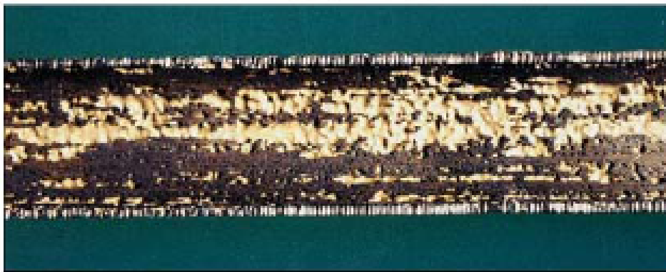
Aufgetrenntes Kupferrohr mit Erosionskorrosion durch Wasser mit hoher Strömungsgeschwindigkeit
