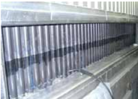
Bild 7 a: Ausschnitt der Kesselisolation zur Installation der Konstantandrähte
