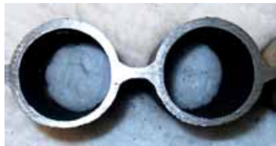
b nicht beschichtete Rohrwand
