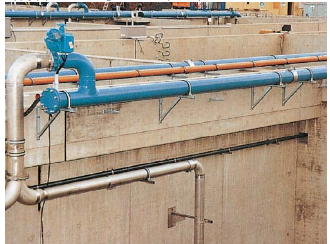
Zuleitungen (Bild unten) in einem Klärwerk Supply pipes in a sewage treatment plant (photo bottom)
