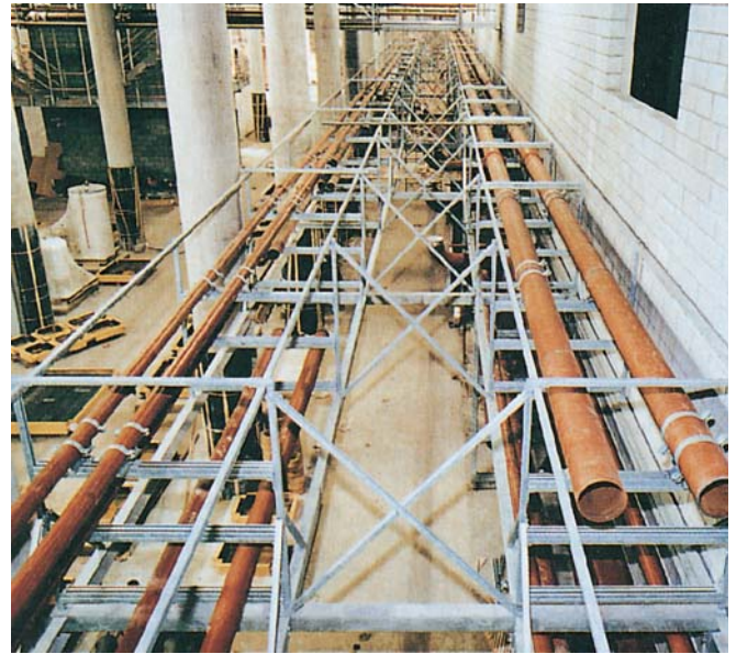
Rohrleitungstrasse auf Stahltragkonstruktion Pipe conduits on a steel framing structure
