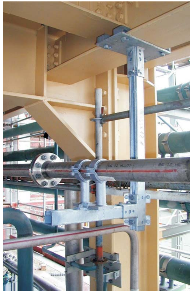
Rohrunterstützung, mit Trägerklemmen an Stahlträger befestigt Pipe support structure, clamped to steel beams
