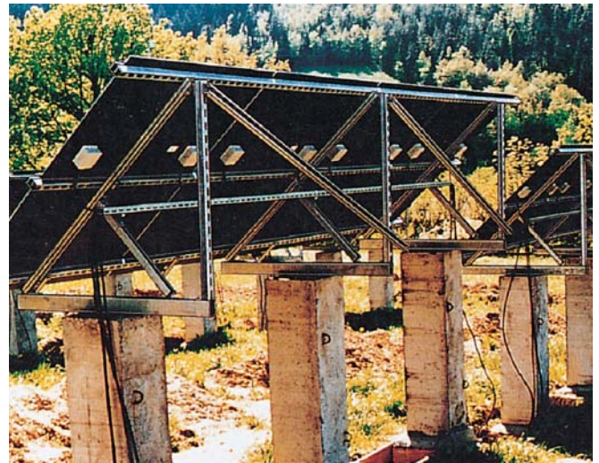
Tragkonstruktion für Photovoltaik-Anlage Support structure for photo-voltaic plant
