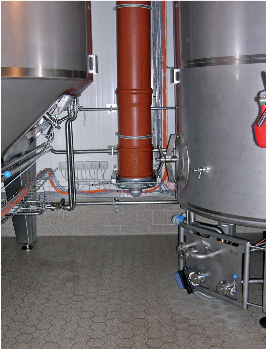
Abb. 5: Beispiel für eine Absaugung der Raumluft in einem Gärkeller
