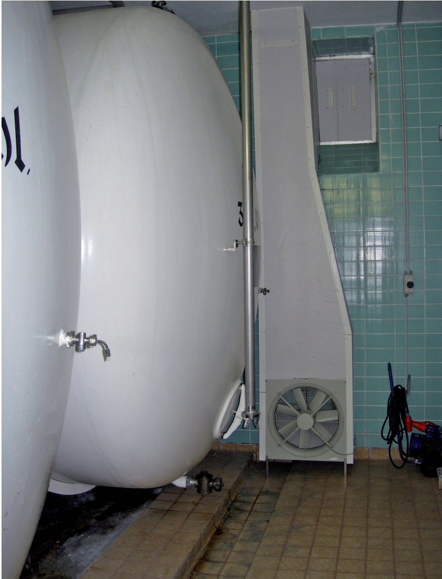
Abb. 6: Beispiel für eine Absaugung der Raumluft in einem Lagerkeller
