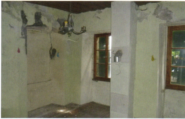
Abb. 19: Raum im Obergeschoss der Rossel vor der Instandsetzung. Die Fenster waren teilweise vermauert.
