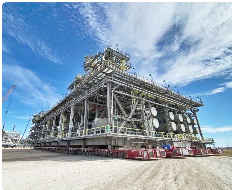
Schwere Last für leichte Ware – die Module einer Kunststoffproduktionsanlage sind in Bewegung. (Bild: Mammoet)
