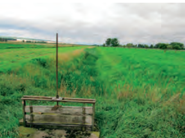
Entwässerungsgraben mit starkem Pflanzenwuchs Foto: Jede
