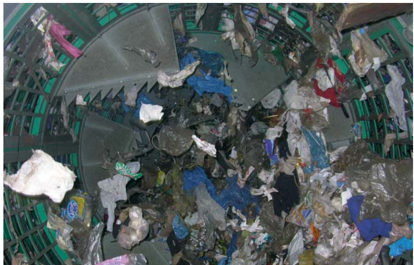
Im Innern der sich drehenden Siebtrommel befinden sich mit Reißzähnen ausgestattete Werkzeuge, die die geschlossenen Abfallsäcke aufreißen.
