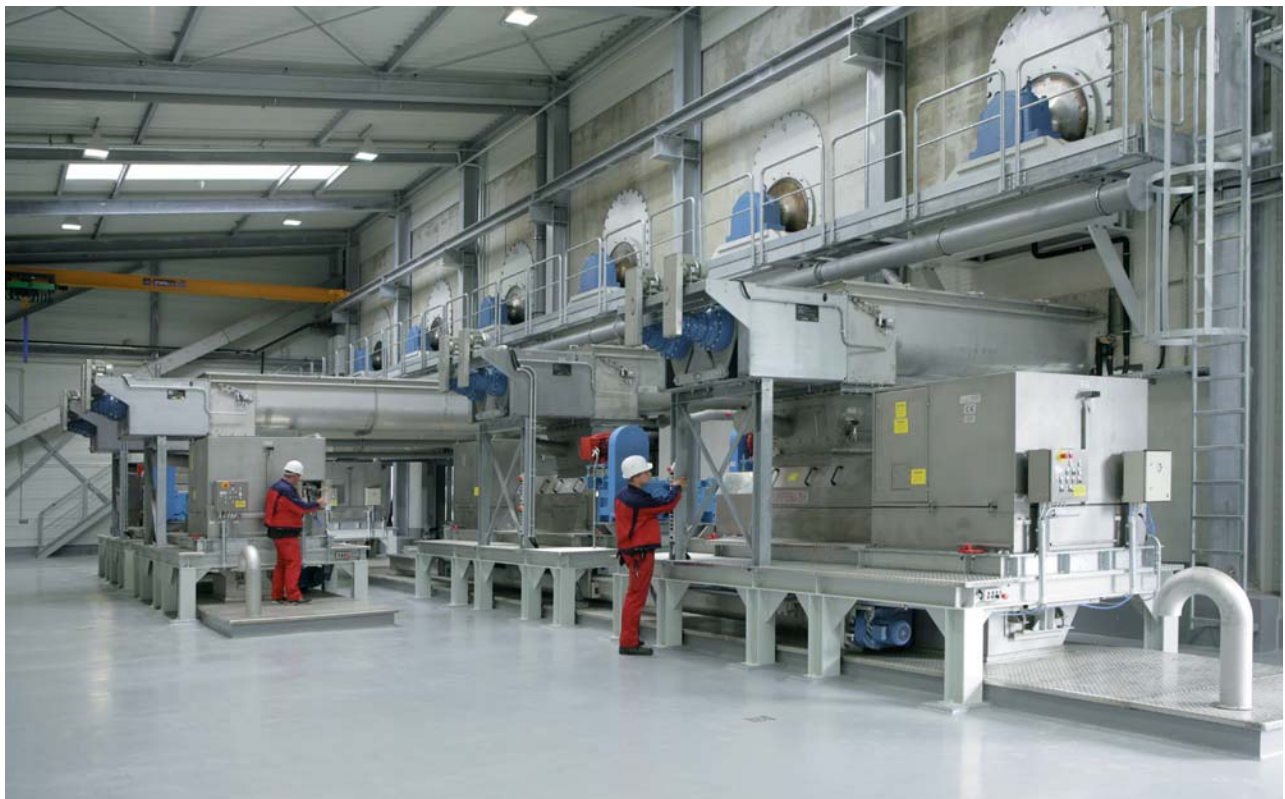
Pressenhalle: Der aus den Perkolatoren ausgetragene, ausgelaugte Feststoff wird in dicht verschlossenen Schneckenpressen mechanisch entwässert.
