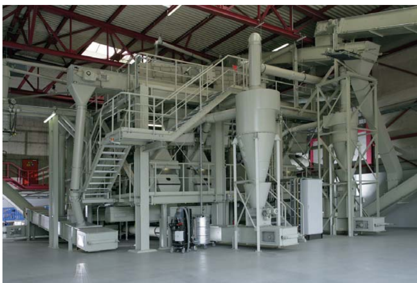
In dieser kompakten Anlage können täglich etwa 160 Tonnen getrocknetes Material in Leicht- und Schwerfraktionen aufgetrennt werden. Sie wurde von der Firma Trennso-Technik GmbH, Weißendorn, geliefert.
