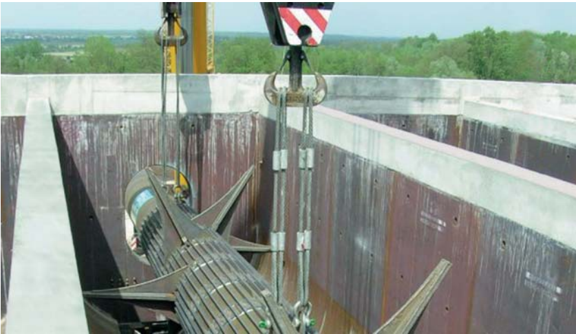
Im Innern des Perkolators wird der Abfall ausgewaschen. Das Bild zeigt den Einbau einer Rührwerkswelle der Firma Wehrle Umwelt GmbH/Wehrle-Werk AG, Emmendingen, die auch den Planungsauftrag für die biologische Umsetzung hatte.
