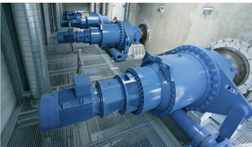
Diese Getriebemotoren der Firma PIV Drives GmbH, Bad Homburg, bewegen die Rührwerkswellen in den Perkolatoren. Das Drehmoment eines Getriebes entspricht in etwa dem Drehmoment von 4000 PKW-Getrieben.
