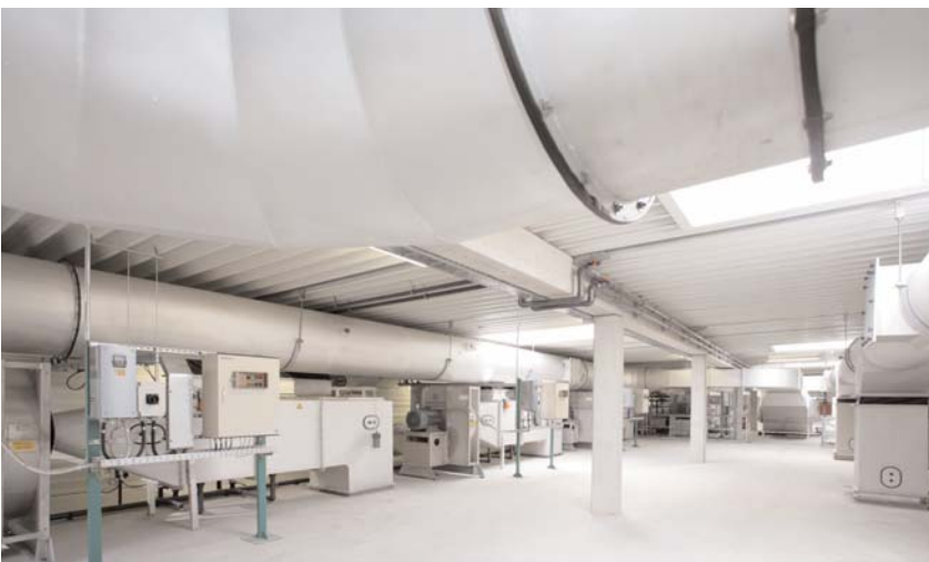
Ventilatorenraum auf den Trocknungstunneln
