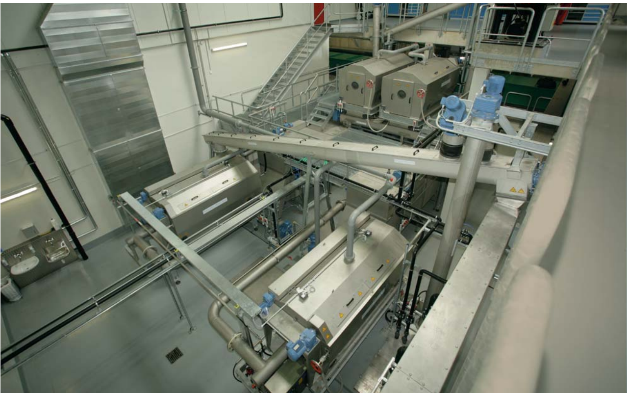
Perkolataufbereitung, geliefert von der Firma Noggerath Products GmbH, Ahnsen: Hier werden diejenigen Feststoffe, die in der Vergärungsstufe stören (Grob- und Faserstoffe, Sand) aus dem Perkolat abgetrennt.
