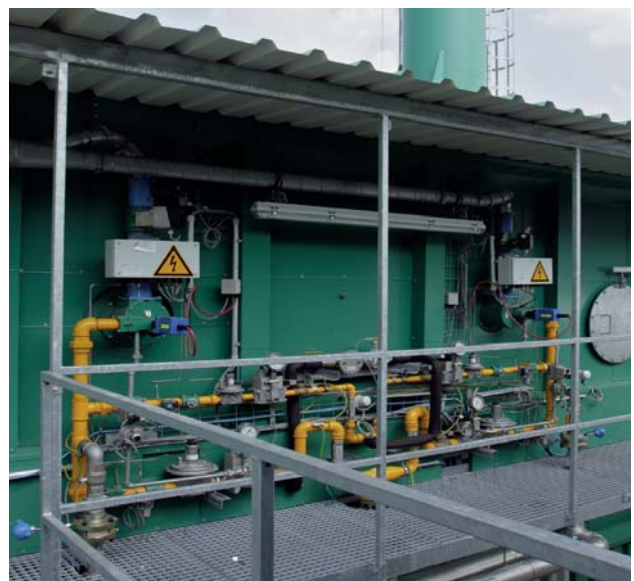
In den RTO-Einheiten werden die in der Prozessabluft enthaltenen Schadstoffe hauptsächlich zu Kohlendioxid und Wasser verbrannt.
