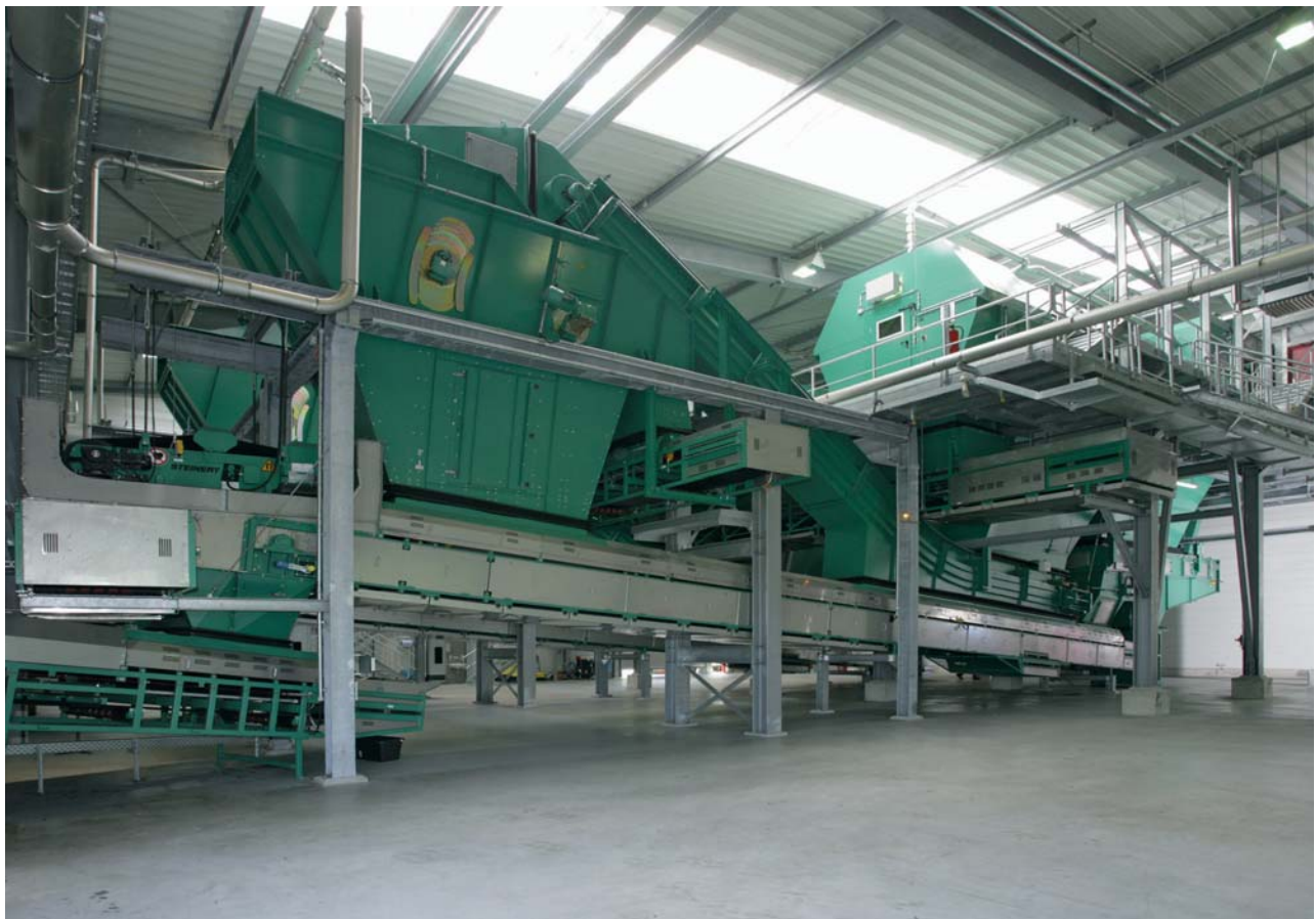
Wichtige Aggregate in der Halle der Mechanischen Aufbereitung: Rechts oben befindet sich die eingekapselte Siebtrommel. Der im Vordergrund sichtbare Ballistiksichter trennt Schwerstoffe ab.
