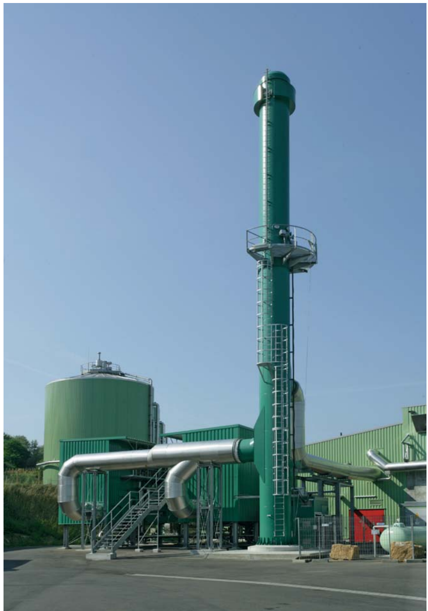
Ostansicht der Abluftbehandlungsanlage. Im Vordergrund ist der 26 Meter hohe Kamin zu sehen. Dahinter liegen die beiden Einheiten der Regenerativ-Thermischen Oxidationsanlage.
