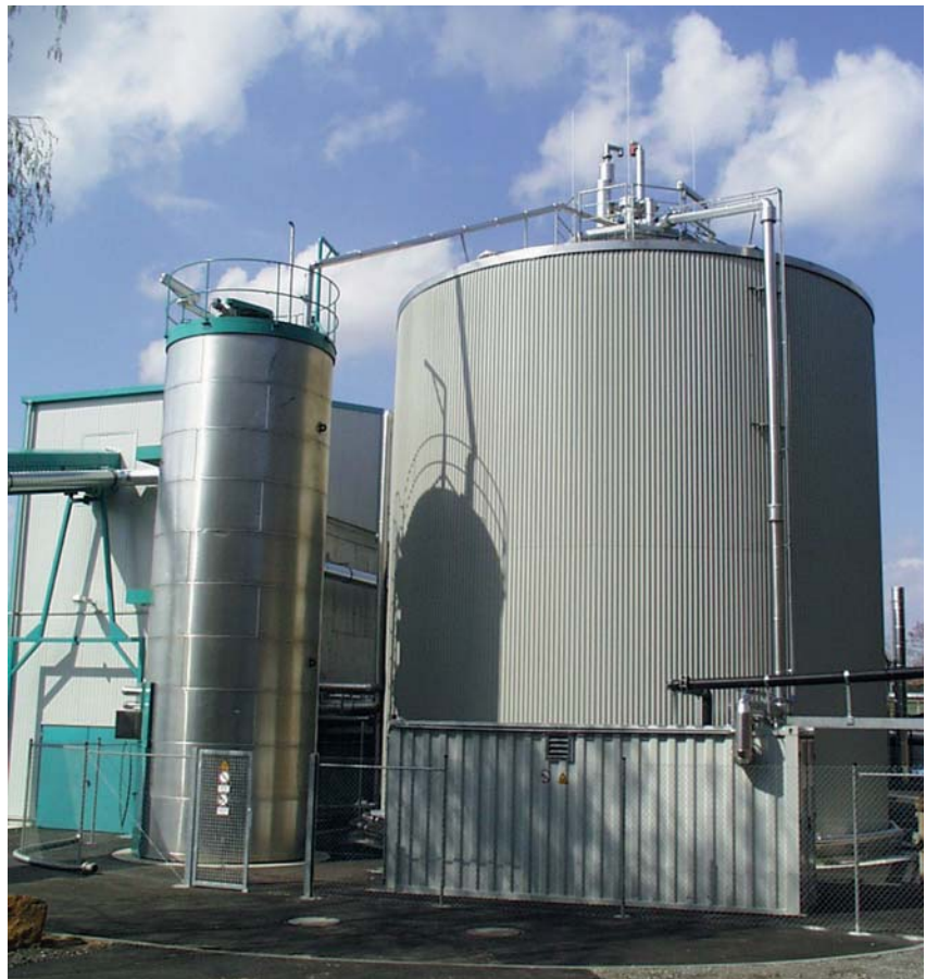
Ansicht der Biologischen Umsetzung in der Demonstrationsanlage, links: geschlossenes Eintragsförderband zum Perkulator, rechts: Biogas-Fermenter, davor: Sedimenter und Gassicherheitscontainer
