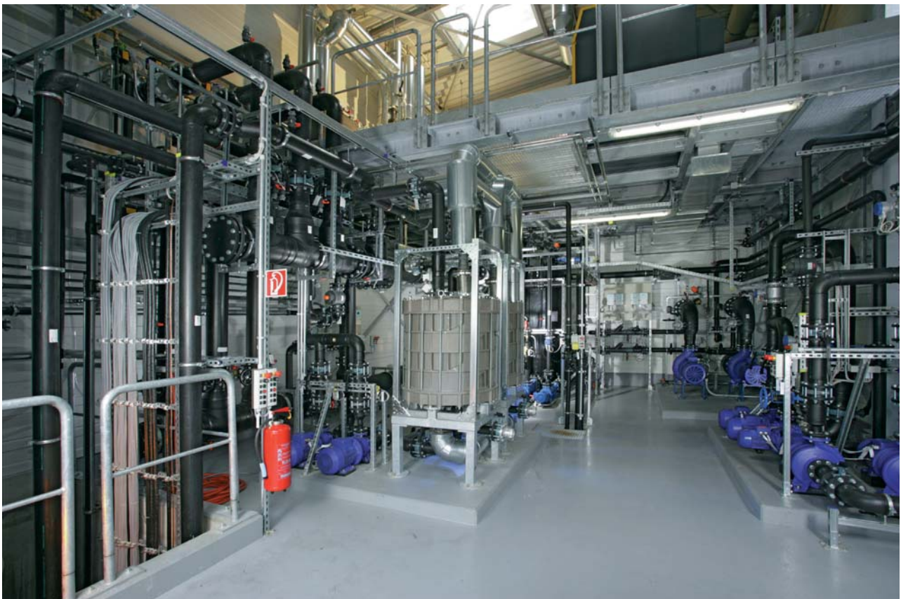
Eine Vielzahl von Pumpen und Rohrleitungen sorgt für die Zu- und Ableitung sowie Verteilung der verschiedenen Wasserströme. Die Montage wurde von der Firma Kürner KTA GmbH, Donaueschingen, ausgeführt.
