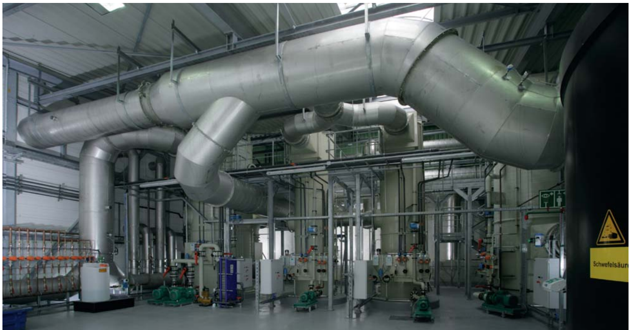
In verschiedenen Luftwäschern im hinteren Bildbereich wird die Abluft auf die weitere Behandlung in der Regenerativ-Thermischen Oxidationsanlage oder den Biofiltern vorbereitet.
