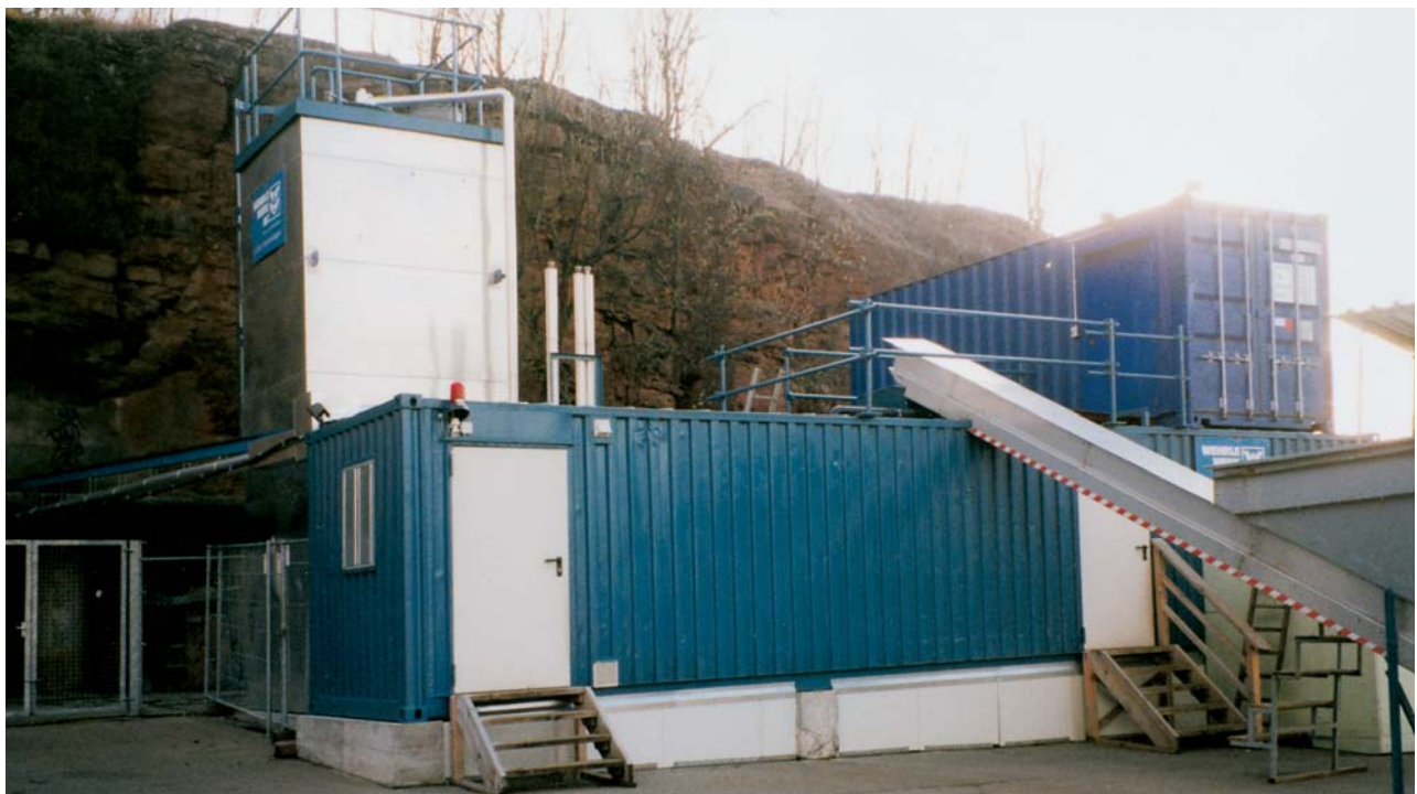
Die ersten Perkolationsversuche auf dem Kahlenberg fanden 1997 statt. Der Durchsatz dieser Anlage in Containerbauweise betrug 1 Tonne pro Tag.
