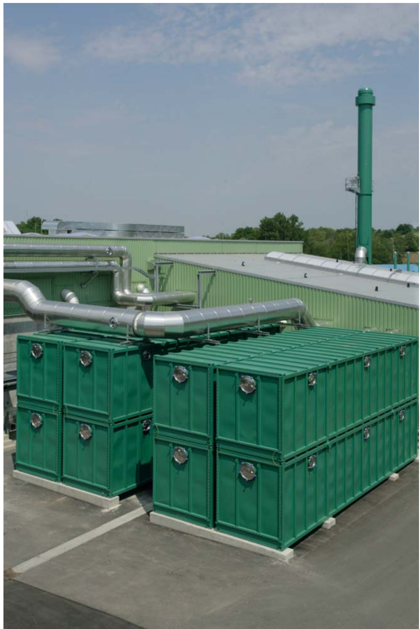
In 8 Biofiltermodulen wird die schwach belastete Hallenluft gereinigt.
