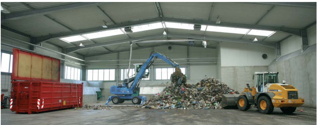
In der Anlieferungshalle beschickt der Mobilbagger die MBA über zwei Aufgabebunker. Zuvor sortiert er Störstoffe in den roten Störstoffcontainer aus. Der Radlader versorgt den Bagger mit dem angelieferten Hausabfall.
