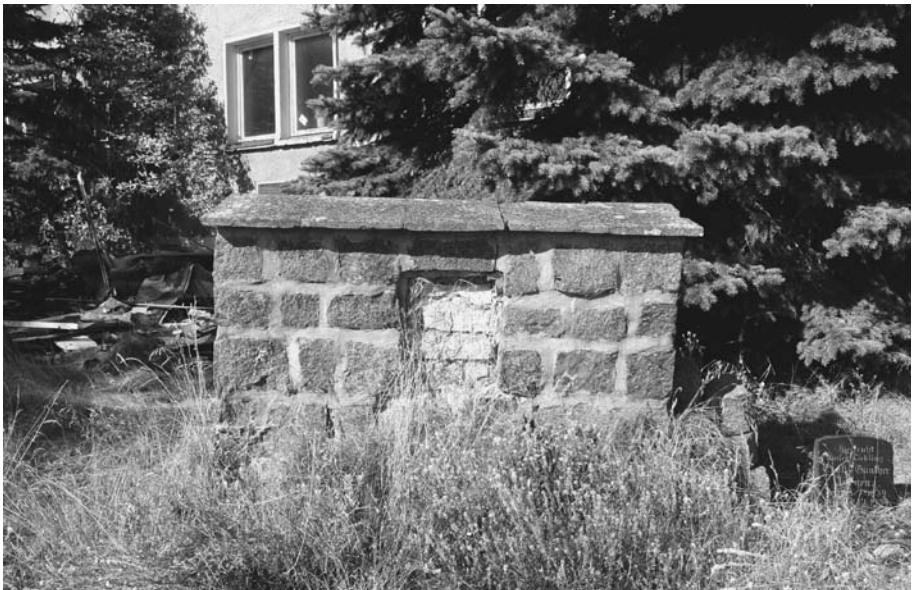
Abb.17 Beschädigtes Denkmal für den Kommunisten Fritz Heckert in einem ehemaligen Kasernenobjekt der Grenztruppen der DDR, 2009
