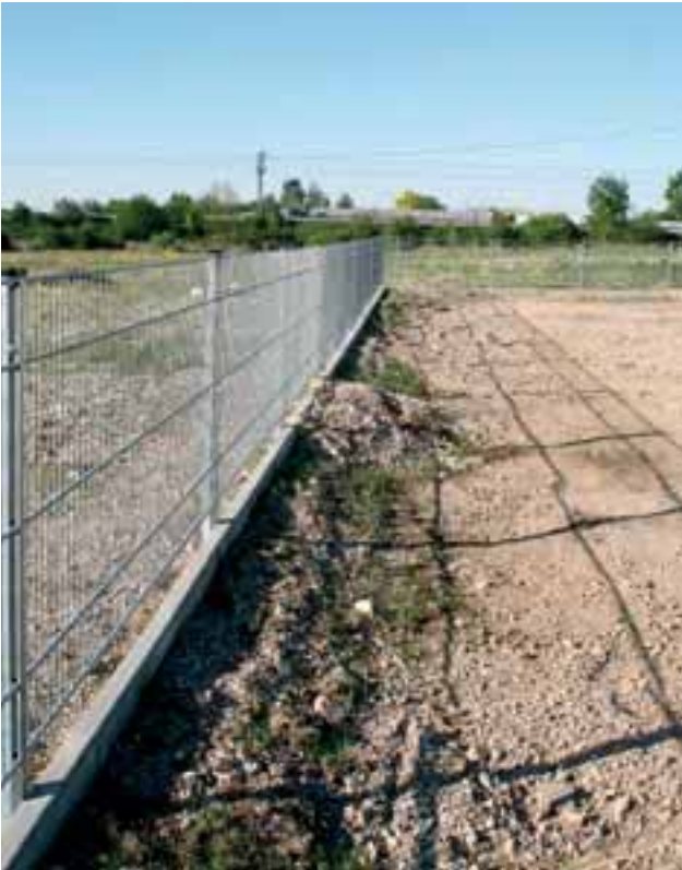
Abbildung 4: Artenschutzoptimierter Bauzaun: Die durchgängige Betonschwelle verhindert, dass Tiere von außen (links im Bild) in den Baustellenbereich vordringen. Von Innen wird die Schwelle aufgeschüttet, so dass Wechselkröten aus dem Baustellenbereich abwandern können. (Foto: Neugebauer)
