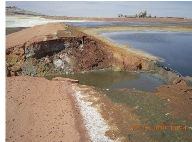
Gebrochener Damm Absetzbecken Niger, AREVA-Mina Imouraren
