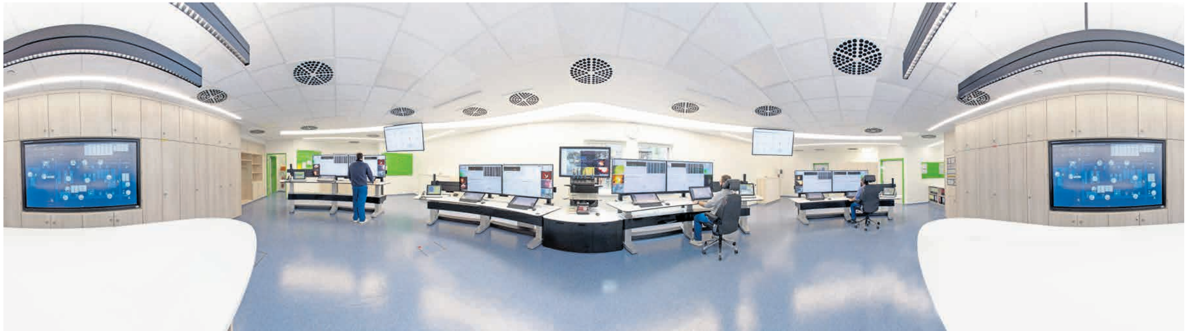
Die Messwarte der Rückstandsverbrennungsanlage (RVA) wurde nach einem innovativen Konzept neu gestaltet.
