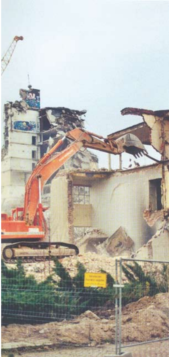
Abb. 4: Absperrung von Gefahrenbereichen als ein Element der Abbrucharweisung
