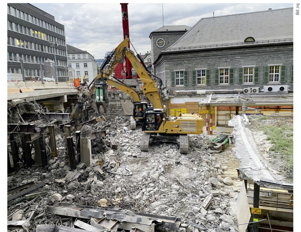
Die engen Platzverhältnisse beim Bahnhof Enge in der Stadt Zürich diktierten das Abbruchverfahren. Am Samstag war von der ersten Hälfte der Brücke nur noch Bauschutt übrig.
