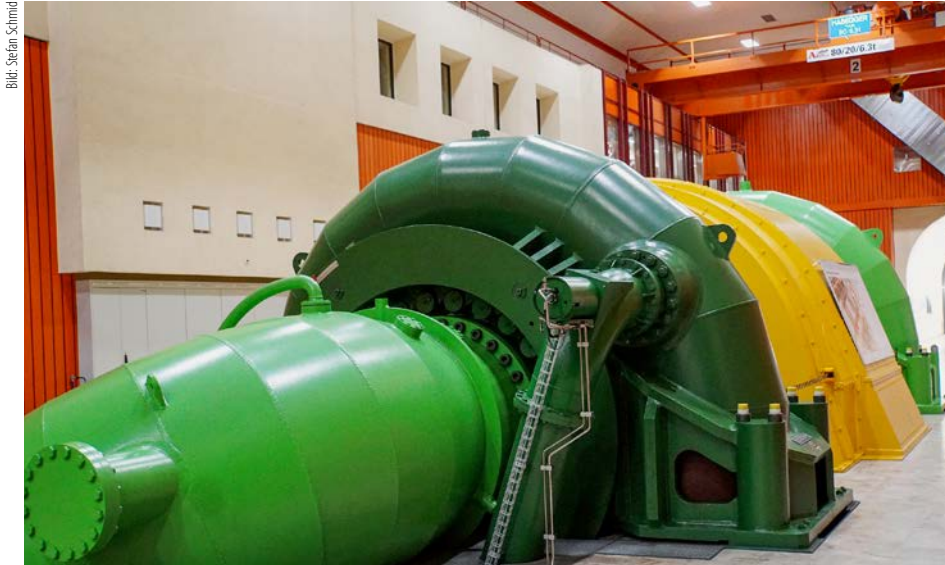
Der Ersatzneubau sichert langfristig die Stromproduktion. Die Anlagen von «Grimsel 2» nutzen bereits das Pumpspeicherprinzip mit der Turbine (grün), Generator (gelb) und Pumpe (hellgrün), mit der das Wasser in den höher gelegenen Speichersee Oberaar befördert wird.
