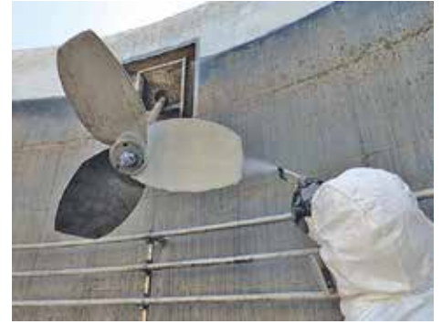
Auftrag der Polyurea-Spritzbeschichtung im Rahmen der Sanierung eines von organischen Säuren angegriffenen Gärbehälters.
