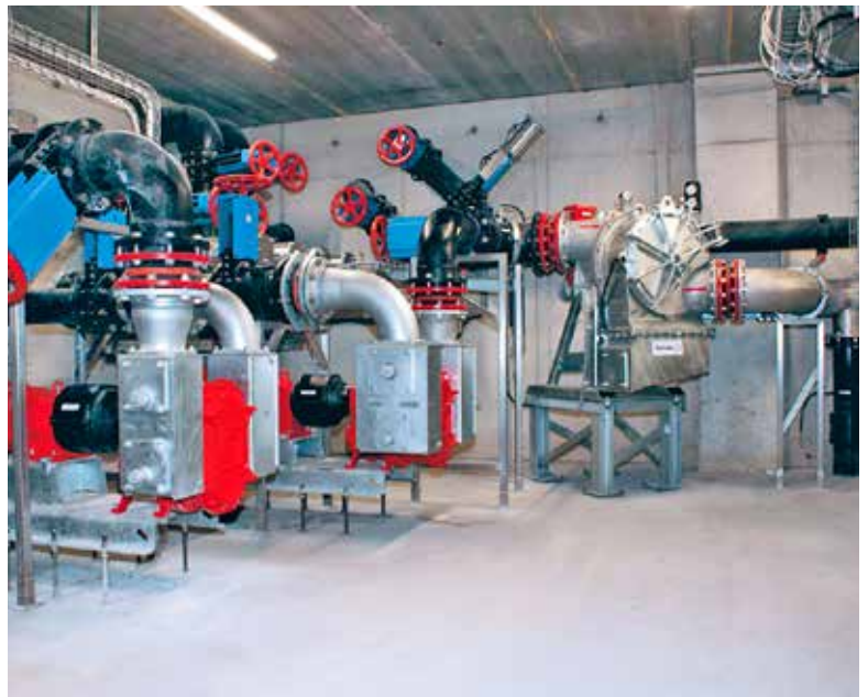
Zwei Drehkolbenpumpen des Herstellers Vogelsang im Einsatz auf einer Biogasanlage. Foto: Vogelsang
