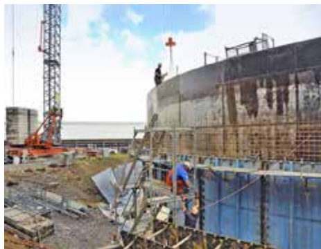
Die Gärtöpfe müssen bei einer Weiterführung der Biogasanlage nach 20 Jahren oft saniert werden. Foto: LfULG
