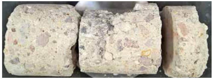
Bohrkern aus dem Fundamentbereich einer Biogasanlage. Im mittleren Bereich ist der Beton durch Säure angegriffen. Foto: BAM/Kühne
