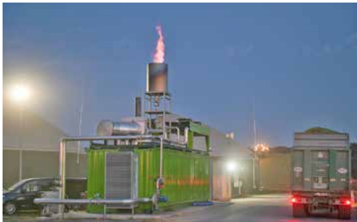
Notfackel der Biogasanlage in Medinci bei Slatina, Slawonien. Noch gibt es vor Ort keine Gaslagerkapazitäten.
