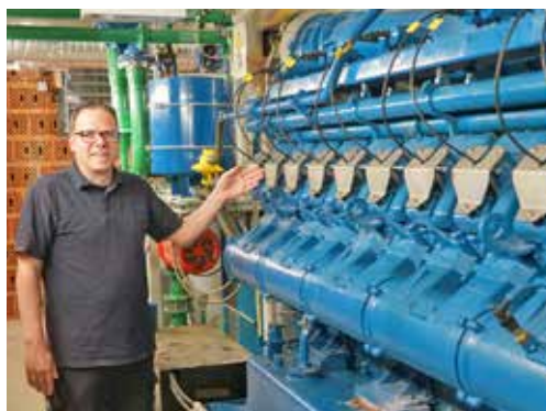
Birger Kanieß vom Agrarservice Lass neben einem der Motoren im Blockheizkraftwerk
