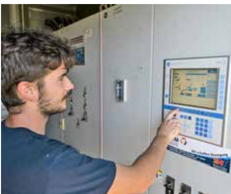
Anlagenleiter Jakob Zvonaric bei der Steuerung der Biogasanlage in Mala Branjevina bei Osijek
