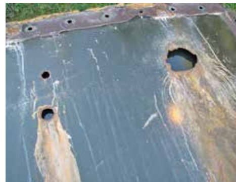
Lochfraß an der Metallkonstruktion einer Biogasanlage Foto: LfULG
