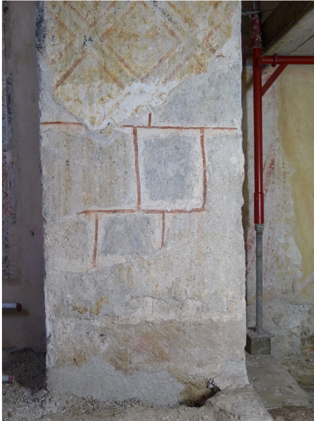
Abb. 1: Erste Dekoration mit geritztem und Rot nachgezogenem Fugenstrich an der südlichen Triumphbogenlaibung
