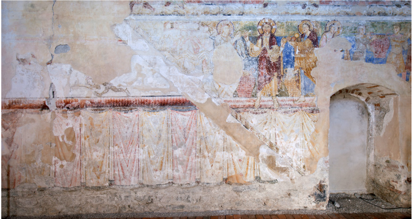
Abb. 3: Nördliche Langhauswand, Zustand nach der Reinigung und nach der Entfernung der schadhafte Kittungen, Aufnahme 2017
