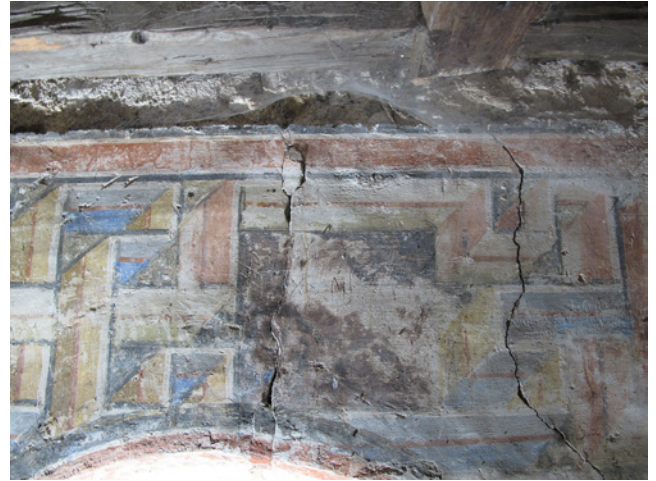
Abb. 12: Risse und lose Putzschollen im Mäanderfries an der Südwand im Langhaus
