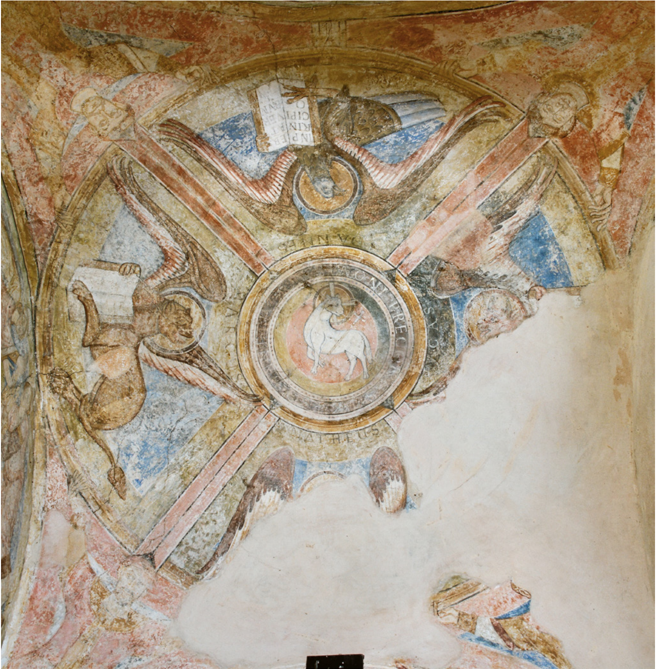
Nr. 6: Chorgewölbe vor der Restaurierung, Aufnahme 2011
