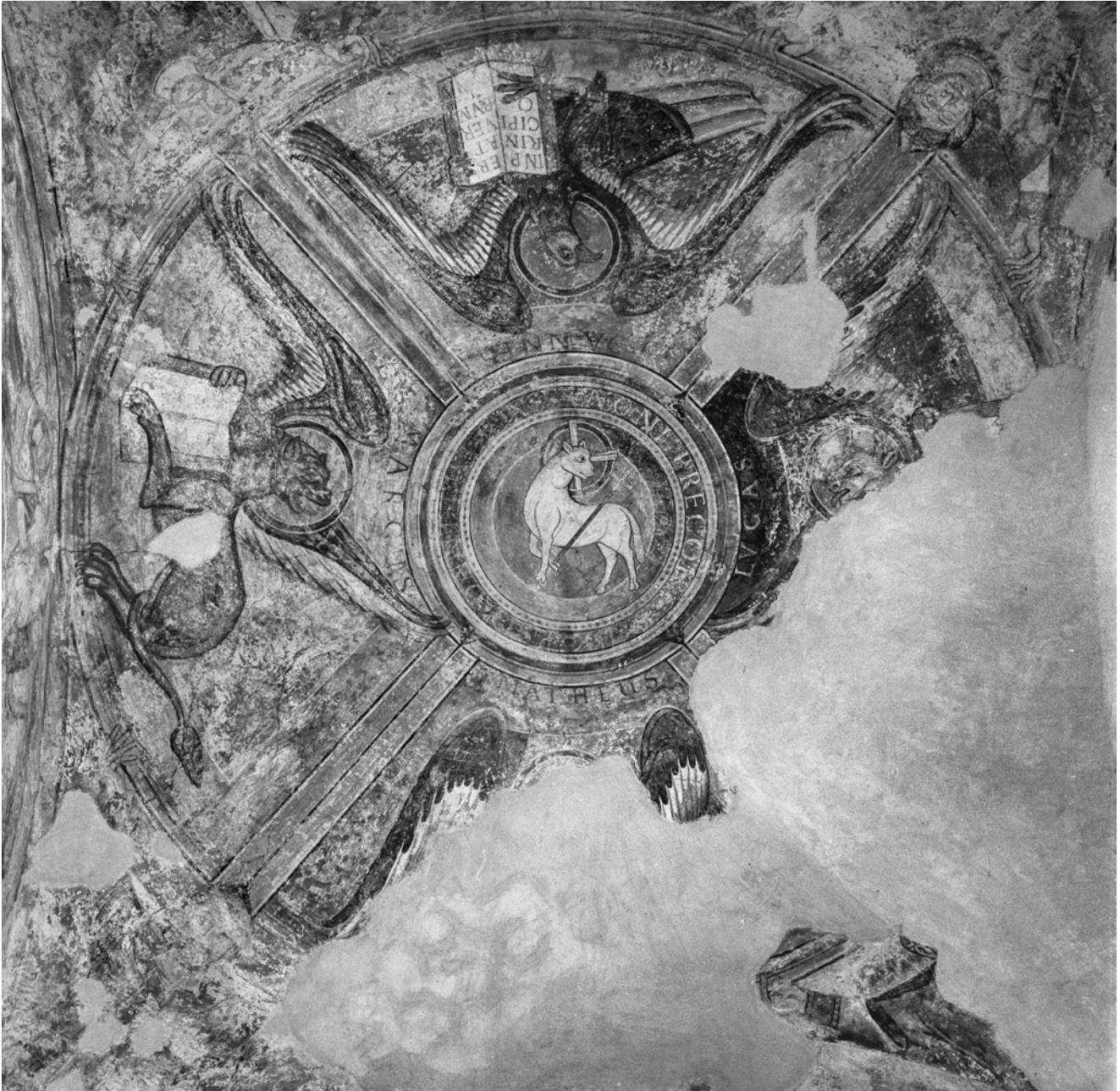
Abb. 7: Blick in das Gewölbe des Chores, die großen Fehlstellen sind bereits wieder mit Kalkmörtel verputzt, Aufnahme 1943
