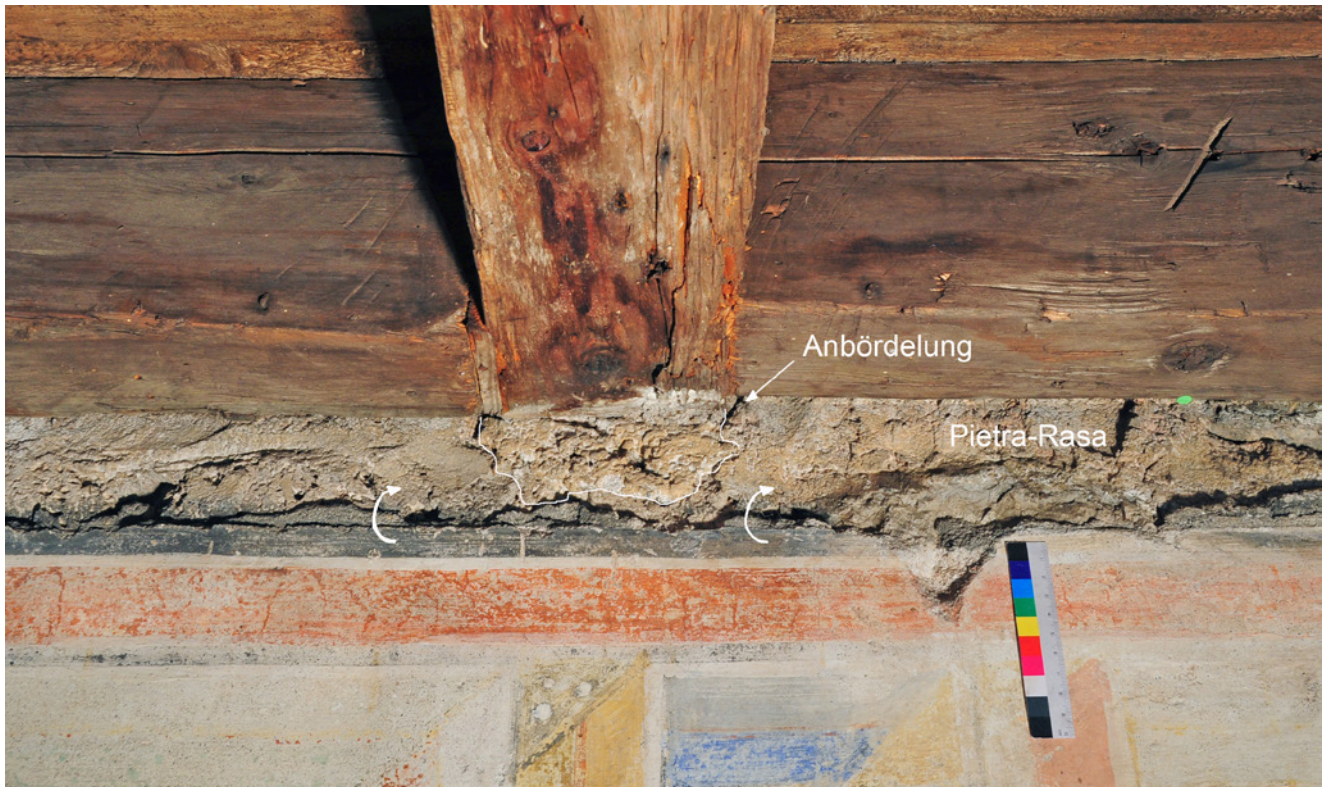
Abb. 8: Pürgg, Johanneskapelle, Südwand Kapellenschiff, 4. Deckenbalken von West: an Balken anstreichender Pietra-Rasa-Mörtel, darüber Malerei mit Abdruck Holzdecke
