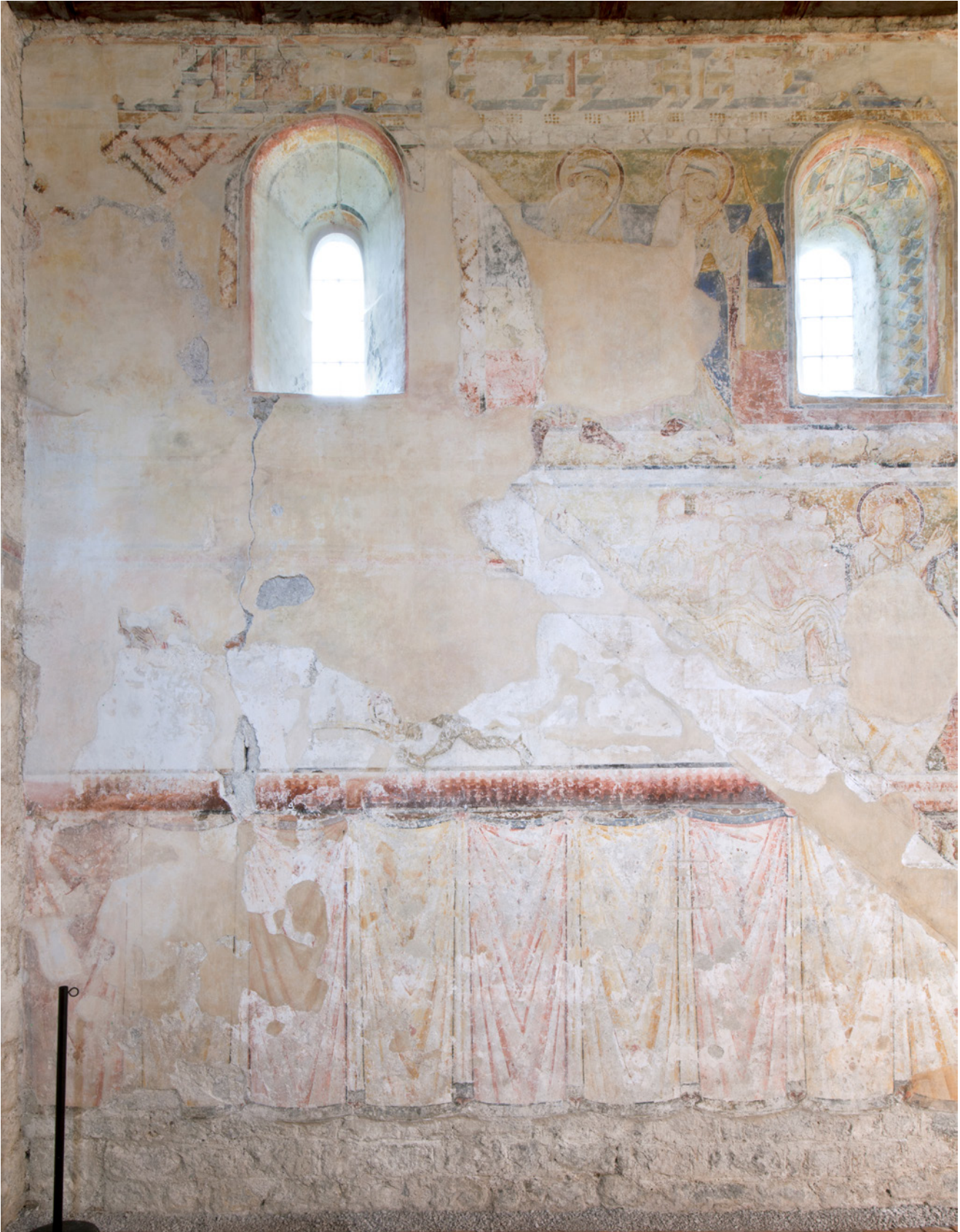
Nr. 14: Linke Hälfte der nördlichen Langhauswand, Zustand nach der Reinigung und Entfernung der schadhafte Kittungen, Aufnahme 2017
