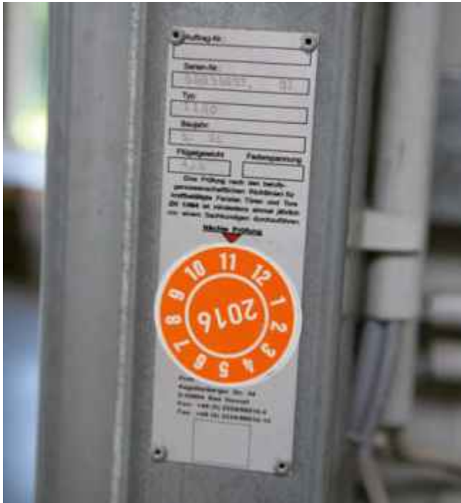
Prüfsiegel an einem elektrischen Rolltor
