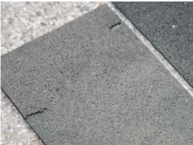
Ablegereife: verschmutzte Oberfläche und ausgebrochene Stellen
