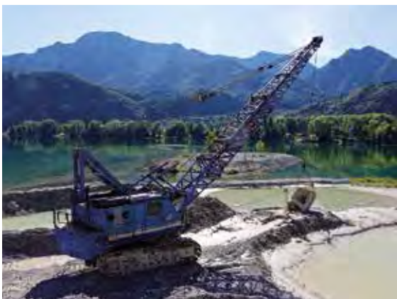
Zur Gewinnung des Geschiebes aus der Mündung der Loisach in den Kochelsee setzt die Rohrdorfer Gruppe einen Schleppschaufelbagger ein, Foto: Rohrdorfer Gruppe (mit frdl. Genehmigung).
