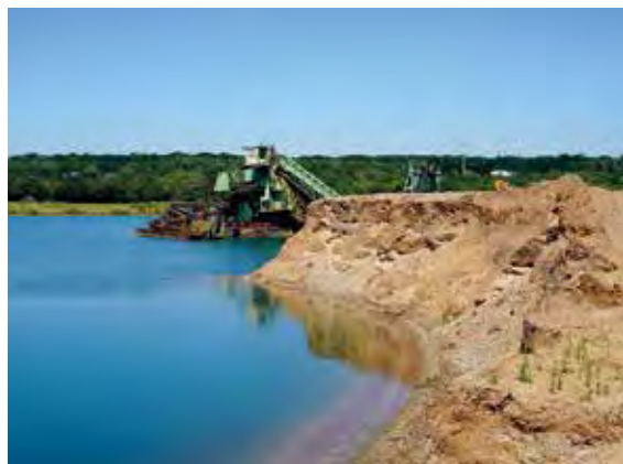
Nördlich Wietersheim erfolgt die Gewinnung der Weserkiessande durch die Kiesbaggerei Lahde / Weser GmbH mit einem schwimmenden Eimerkettenbagger, wodurch sich die Uferschwalben, die in dem darüber lagerndem Auelehm ihre Bruthöhlen bauen, nicht stören lassen, Foto: BGR.
