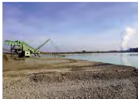
Bei Gundelfingen a. d. Donau haben sich die Familienunternehmen Fetzer GmbH & Co. KG und Gustav Wager GmbH & Co. KG zu einer gemeinsamen Kiesgewinnungsgesellschaft zusammengeschlossen, Foto: BGR.
