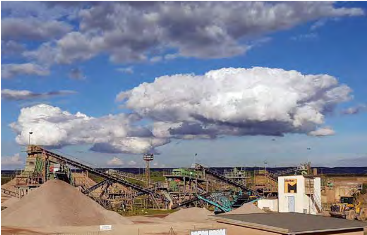
Das KW Arnstadt liegt am östlichen Stadtrand von Arnstadt und produziert vor allem Gesteinskörnungen für die Transportbetonindustrie, Foto: Märker Kies GmbH (mit frdl. Genehmigung).
