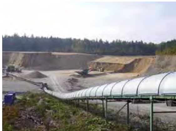
Das KW Gräfelfing der Bernhard Glück Kies-Sand-Hartsteinsplitt GmbH wird seit über 50 Jahren aus einem Abbaugelände in Planegg mit Rohmaterial versorgt. Der Transport erfolgt über ein 2,5 km langes, größtenteils in einem unterirdischen Tunnel verlegtes Förderband, Foto: BGR.
