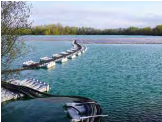
Auf einem Teil des Baggersees der Ossola GmbH in Achern-Maiwald erzeugt seit dem Jahr 2019 eine 750 kWp-Photovoltaikanlage Solarstrom für das angrenzende Kieswerk, Foto: BGR.
