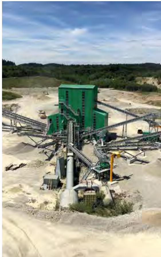
Das hochmoderne KW Wolfegg-Roßberg produziert jährlich große Mengen hochwertiger Gesteinskörnungen für Kunden in der Region, aber auch für Verbraucher entlang des Alpenrheins, Foto: Ernst Marschall GmbH Co. KG Kies- und Schotterwerke (mit frdl. Genehmigung).
