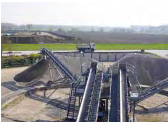
Im KW Waldsee der Rohr-Unternehmensgruppe werden hochwertige Sande und Kiese erzeugt, während auf der Erweiterungsfläche (Hintergrund) die Abraumarbeiten für den sich nähernden Saugbagger laufen, Foto: BGR.
