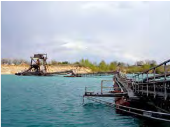
Im KW Durmersheim der Kies und Beton AG erfolgt die Gewinnung der rund 35 m mächtigen Kiessande mittels Schwimmgreifer. Die über dem Grundwasserspiegel lagernden Kiessande brechen beständig in den Baggersee nach, Foto: BGR.
