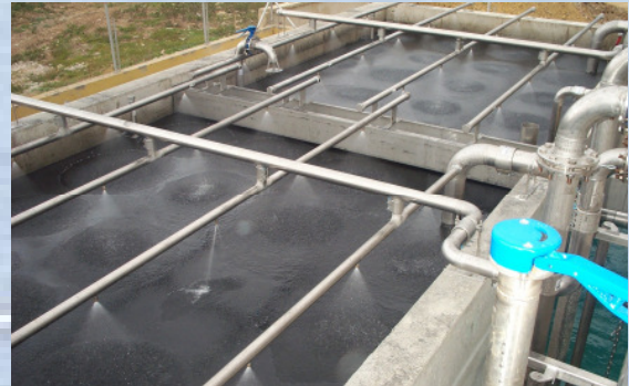
Bestehende HOK-Aufbereitungsanlage zur Aufbereitung von Problemabwasser
