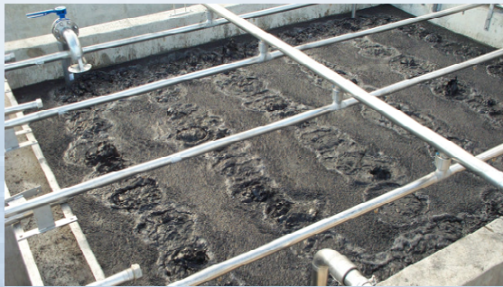
HOK-Reaktor eines Textilbetriebs in Marokko (Einbringen von Druckluft über am Boden liegende Verteilerrohre)
