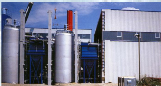
Biologische Kläranlage einer Textilfabrik mit Anwendung von Herdofenkoks als biogenes Trägermaterial.
